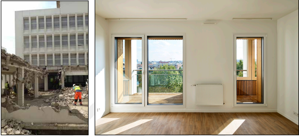
Şekil 3.8. 90 Housing And Office Yıkılan Bölüm (Anonim 2) (Solda)
