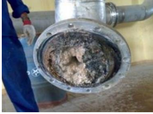
Şekil 1. İstenmeyen strüvit oluşumu sebebiyle tıkanan boru (Fattah, 2012)
