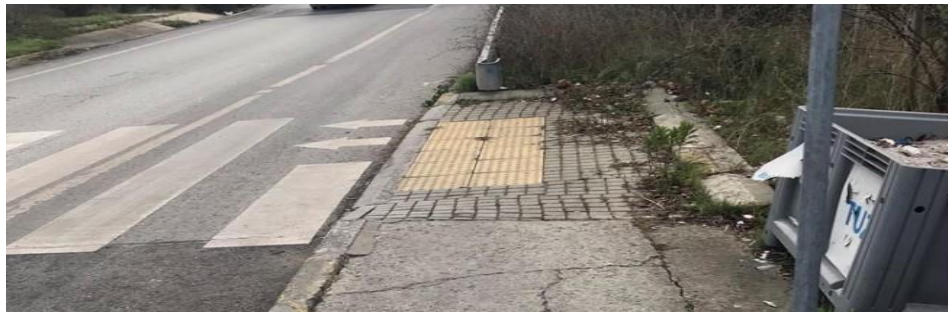
Şekil 4. Hatalı Hissedilebilir Yüzey Uygulaması
