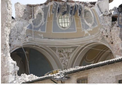
Şekil 3. 12 L'Aquila 2009 depremi Santa Maria Paganica Kilisesi (Clayton, 2013).
