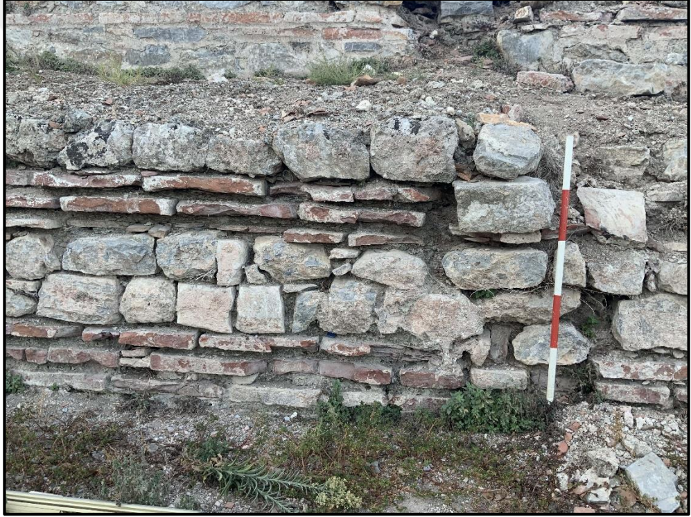
Resim 49: Ephesos Liman caddesi ile tiyatro birleşim noktası Roma Çağı surlarına geç dönem onarımları (güçlendirmeleri).
