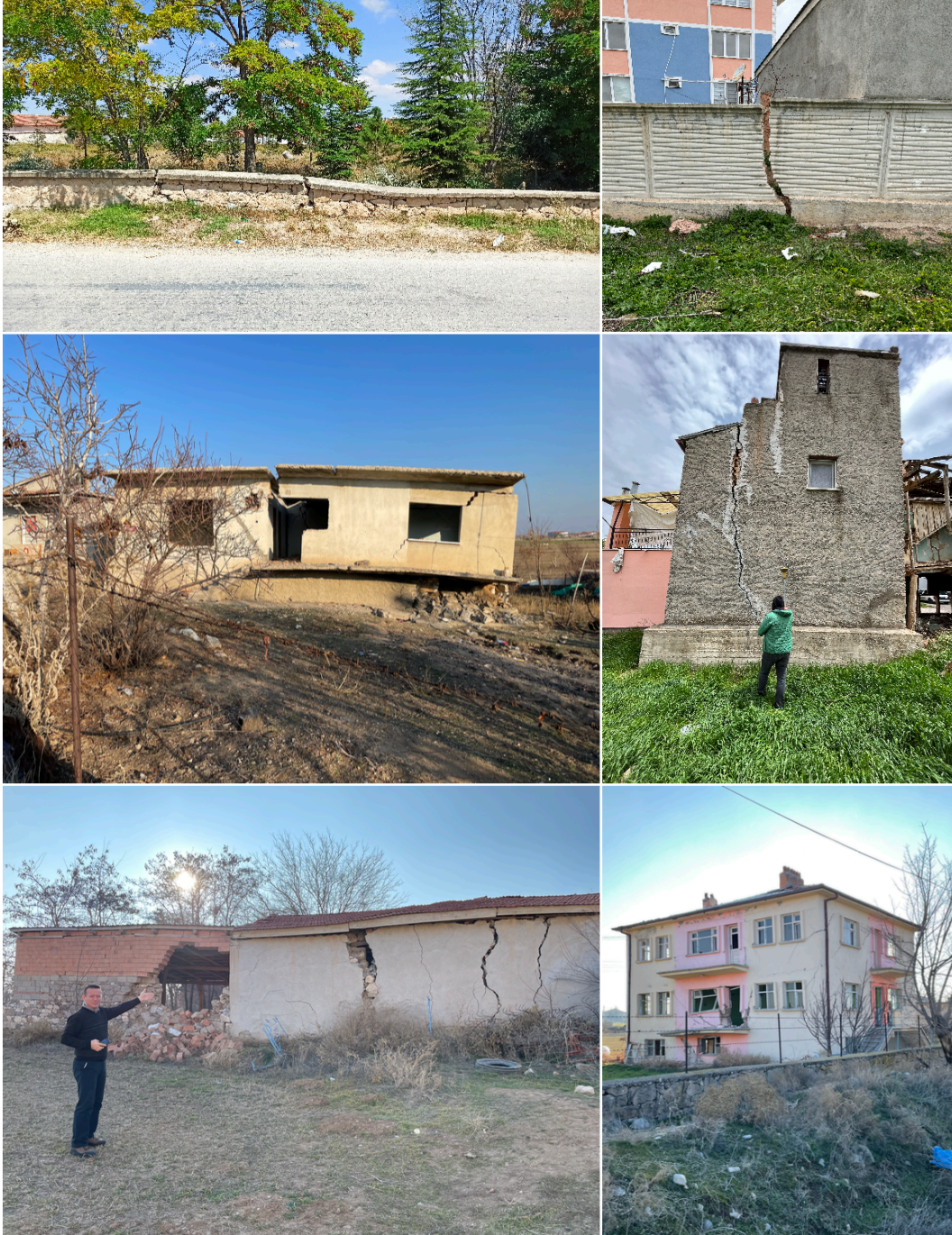
Resim 3.3 Bolvadin ilçesinde yapılarda gözlenen deformasyonlar.
