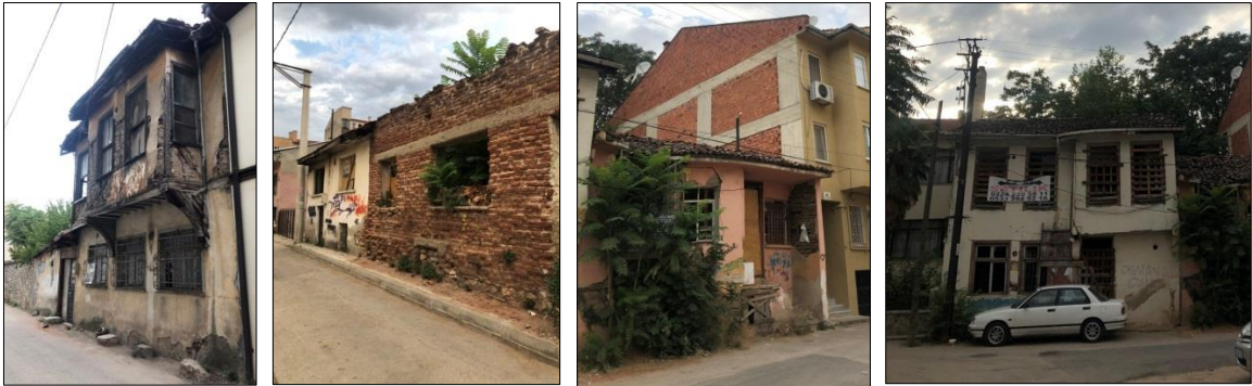
Şekil 44. Bölgede bulunan harabe durumundaki konutlar
