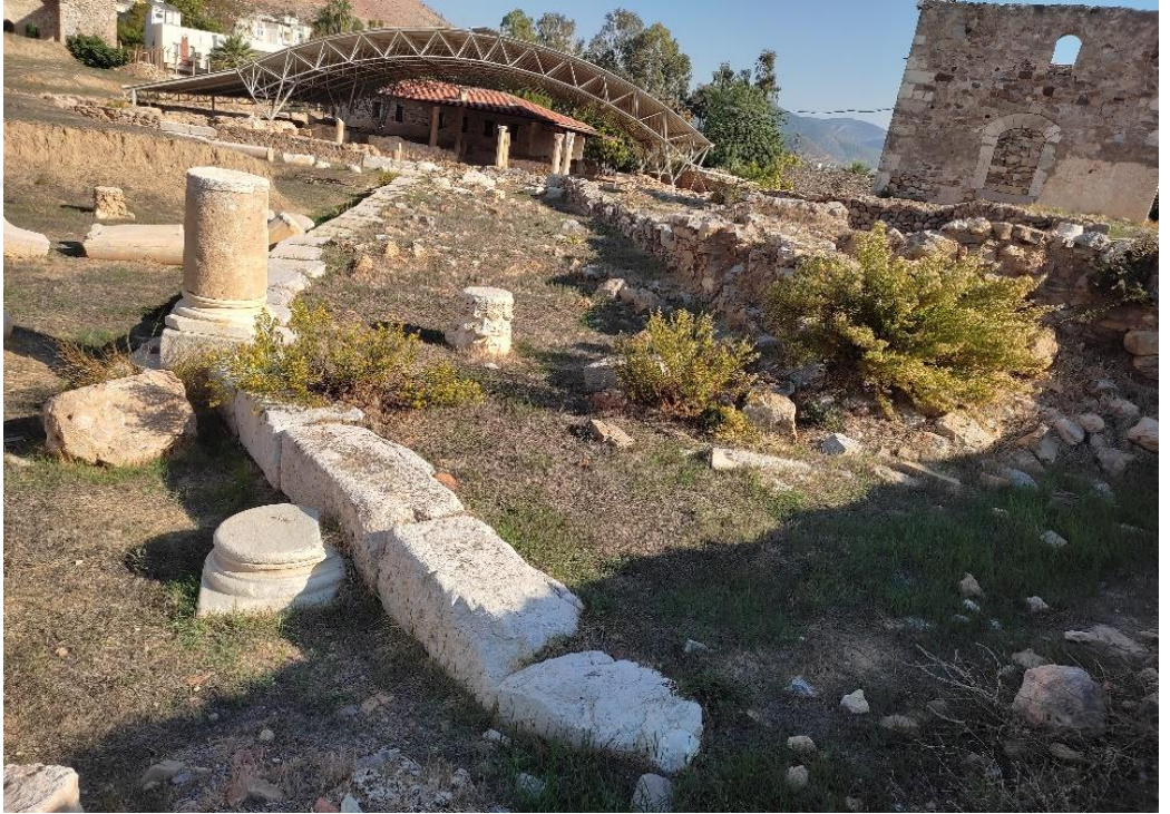
Şekil 4.9. Kelenderis tapınağının tahrip olmuş güneybatı kısmı (Hacer DEĞİRMENCİ)
