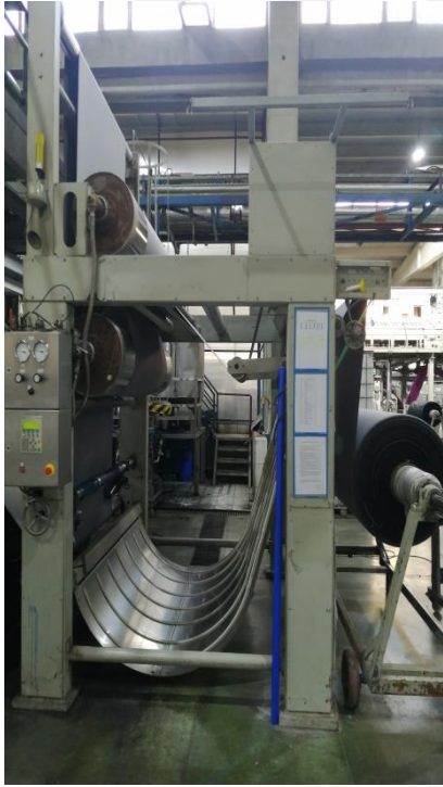
Şekil 3.8. E Kontrol Giriş ve J-box
