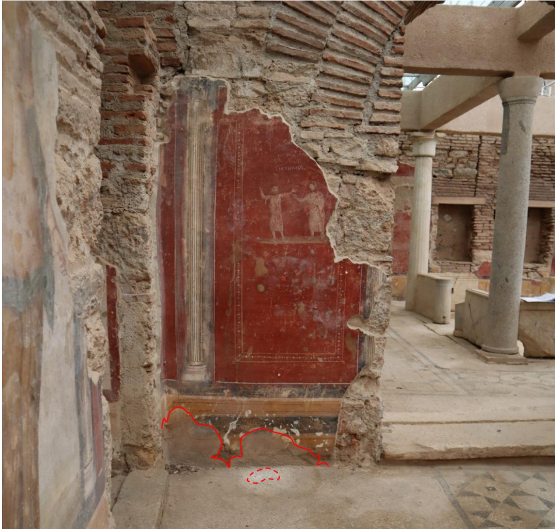
Resim 5.16. Konut birimi 1, SR 6 batı duvarı güneyi, örtüden damlayan suyun zemine düştüğü alan ve boya tabası üzerinde, duvar resmi zemininden yükselen nemin yol açtığı tuzlanma (Kişisel Arşiv).
