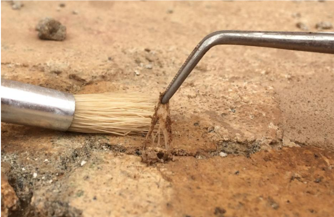
Resim 5.32. 2019 yılı duvar resmi koruma ve onarım çalışmalarında SR 18 batı duvarında tespit edilen, niteliğini yitirmiş eski onarım malzemesi (Ephesos Yamaç Ev 2 Koruma-Onarım Projesi Arşivi).
