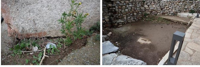
Resim 6.1. Solda, koruma binası güney doğu köşesi zemininde görülen açıklık ve otsu bitki gelişimi ve sağda, koruma binası güney doğusunda yağmur sularının havuzlandığı alan (Kişisel Arşiv).
