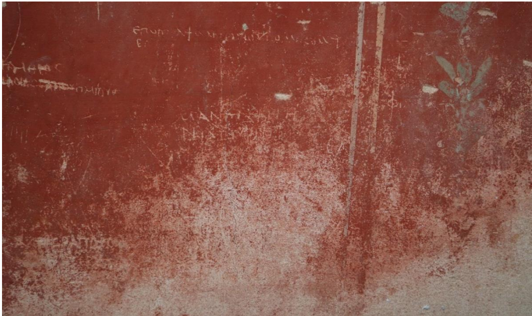
Resim 5.20. Detay, konut birimi 7, 38b güney cephesinin batısında görülen aşınma ve boya tabakası kaybı (Kişisel Arşiv).
