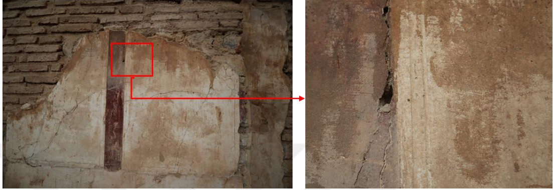
Resim 5.30. Konut birimi 1 SR 3 doğu duvarı, akrilik reçine ile facing uygulaması yapılan yüzeyde sararma ve sağda detay görünümü, akrilik reçine kalıntılarının sararması ile belirginleşen tekstil izleri (Ephesos Yamaç Ev 2 Koruma-Onarım Projesi Arşivi).
