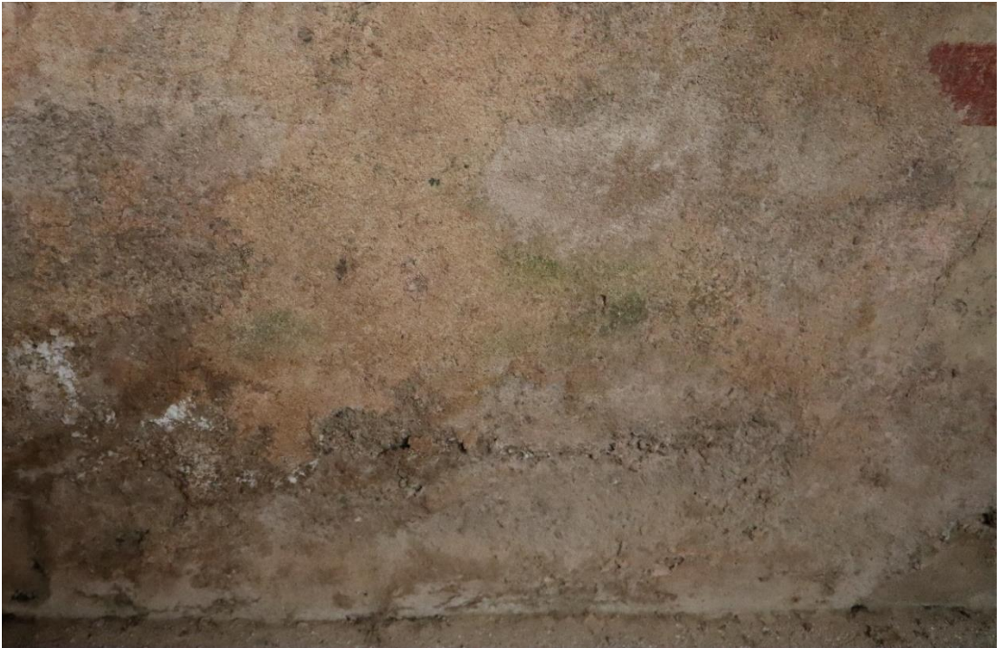
Resim 5.3. Detay, konut birimi 1, GEW A güney duvarında mikroorganizma oluşumu ve tuzlanma (Kişisel Arşiv).
