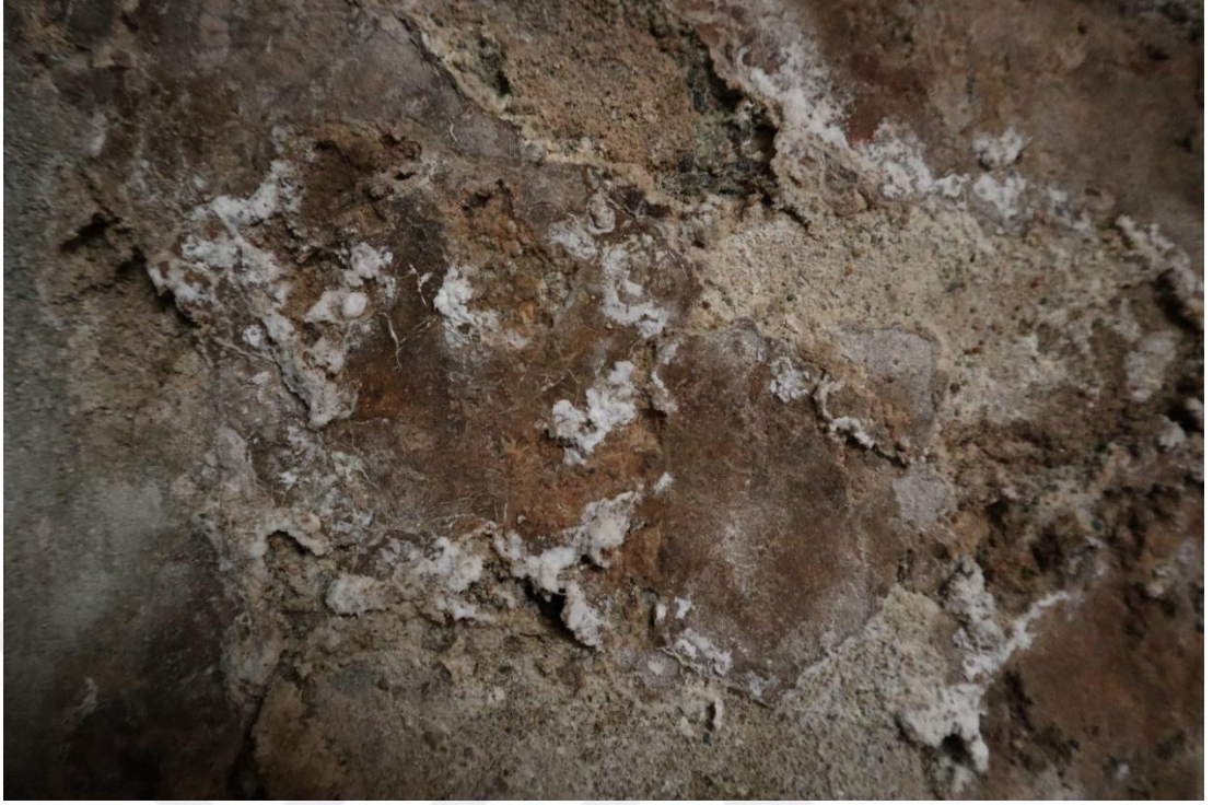
Resim 5.2. Detay, konut birimi 1, GEW A güney duvarında tuz çiçeklenmesi ve kalker tabakası (Kişisel Arşiv).
