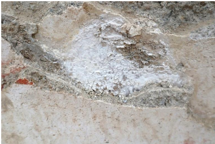
Resim 6.15. Konut birimi 5, B19 mekanı güney cephesinde parça kopması olan alan ve etkinliğini yitirmiş önceki onarım malzemeleri (Kişisel Arşiv).
