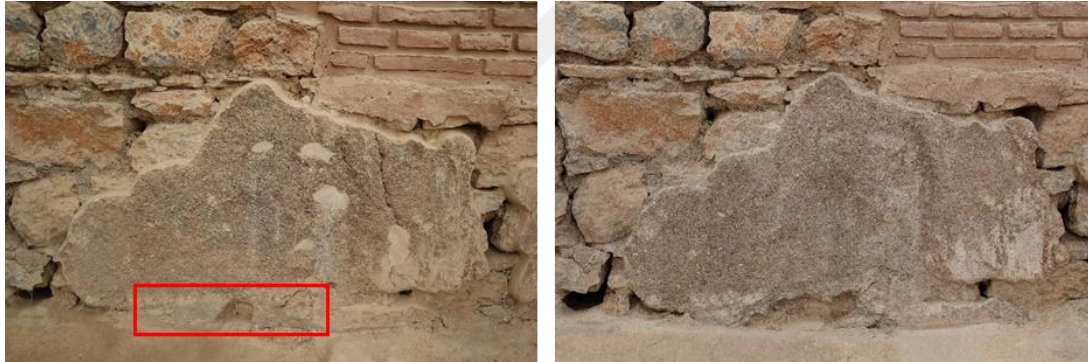
Resim 5.29. Konut birimi 2, SR 14 batı duvarı kuzeyi; solda, 2021 yılı alan incelemesinde genel görünümü, 2. evrede müdahale edilmeyen çimentolu harç ve bu evrede yapılan harç onarımları ve sağda, 2022 yılı duvar resmi koruma ve onarım çalışmaları sırasında genel görünümü (Ephesos Yamaç Ev 2 Koruma-Onarım Projesi Arşivi).
