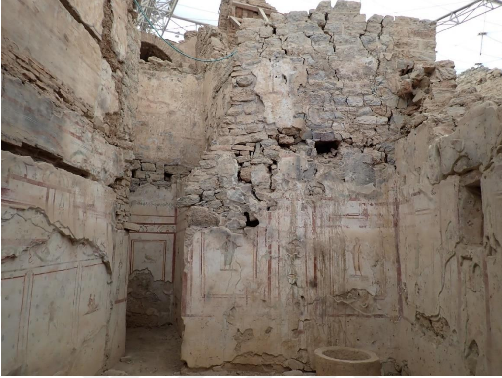
Resim 5.5. 45b mekânı güney duvarı, yapısal çatlaklar, deformasyon, duvar örgüsünde birim parça kayıpları ve çatlak oluşumları ile duvar resminde parça kayıpları, 2022 yılında görünümü (Kişisel Arşiv).
