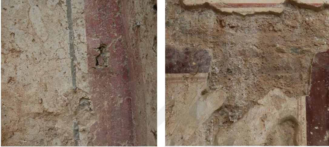
Resim 5.33. Solda, konut birimi 2 SR 25 batı duvarı kuzeyinde görülen çimento akıntısı ve sağda, konut birimi 4 mekan 15 batı duvarı güneyinde enjeksiyon harcı sızıntısının yol açtığı beyaz pus ve akıntılar (Kişisel Arşiv).
