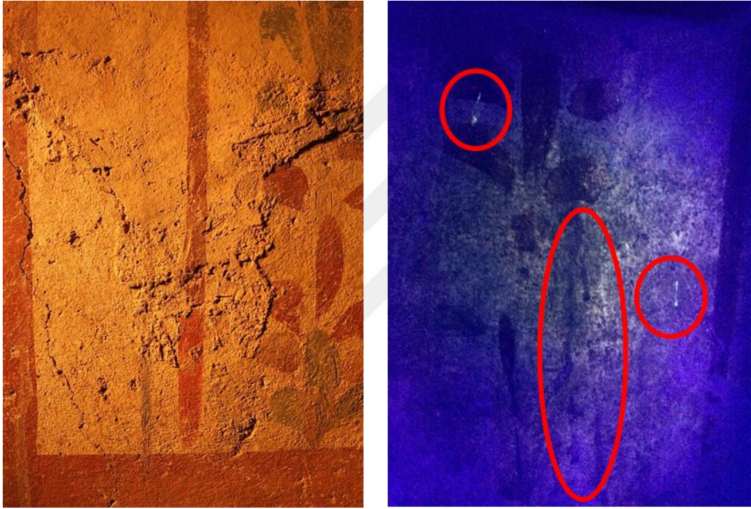
Resim 4.19. Detay, SR 18 batı duvarı, 2019 yılı duvar resmi koruma ve onarım çalışmaları; solda, yan ışık altında tespit edilen antik onarım ve sağda, mor ışık altında tespit edilen önceki onarım evrelerine ait yüzey sağlamlaştırıcı artıkları; akma ve damlamalar (Ephesos Yamaç Ev 2 Koruma-Onarım Projesi Arşivi).
