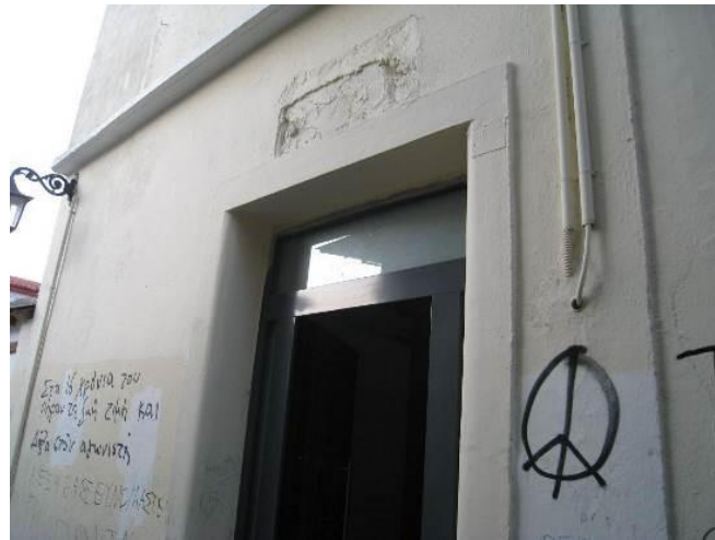
*İTB'nin Giriş Kapısı (Tabelası Sökülmüş)
