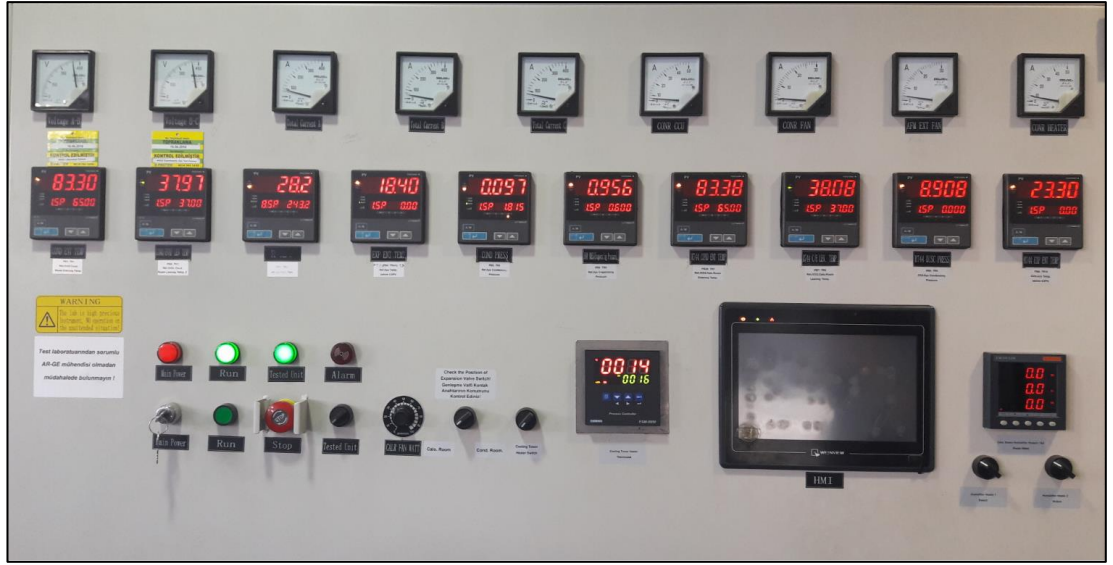
Şekil 5.7: Test Sistemi Kontrol Panosu.
