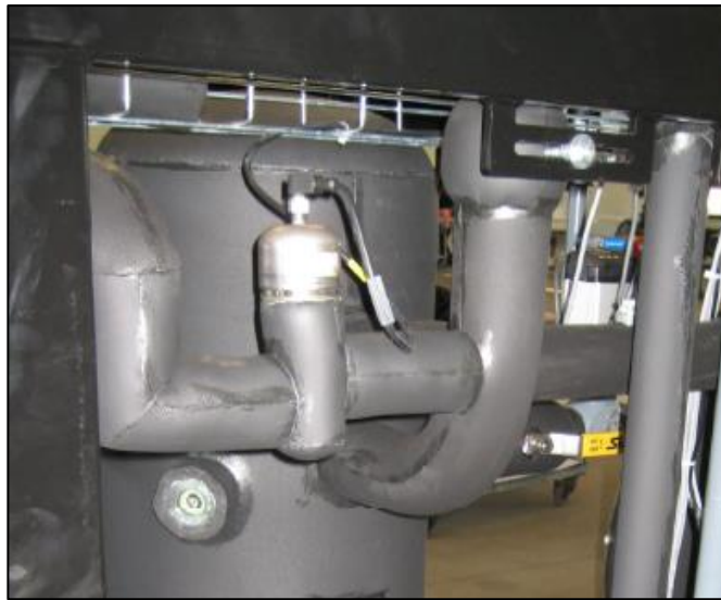
Şekil 5.13: Gaz By-Pass Vanası.
