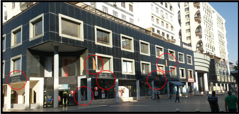
Şekil 4.22. Diyar Galeria AVM ön cephedeki bozulmalar
