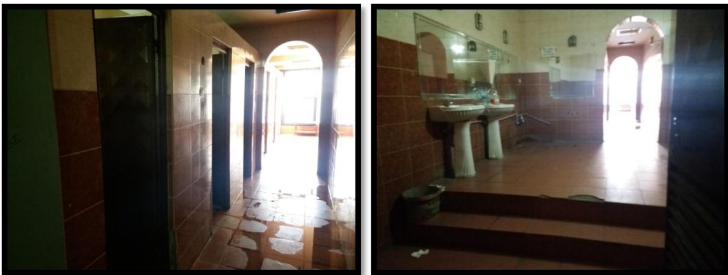
Şekil 4.16. Bayan lavabo içten görünüm
