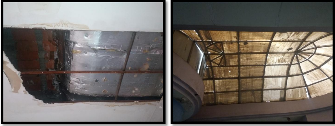
Şekil 4.24. Diyar Galeria AVM çatısı fiziksel bozulmalar
