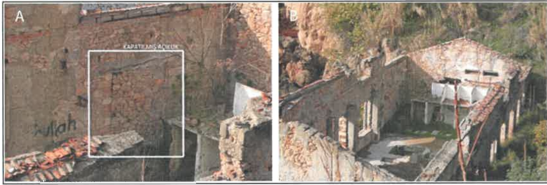
Şekil 4. 70. (a) Antalya Elektrik Fabrikası'nın kapatılmış açıklıkları, (b) Fabrika yapısının ana beden duvarlarındaki taş-tuğla malzemede kayıplar (Yaren Şekerci Arşivi)
