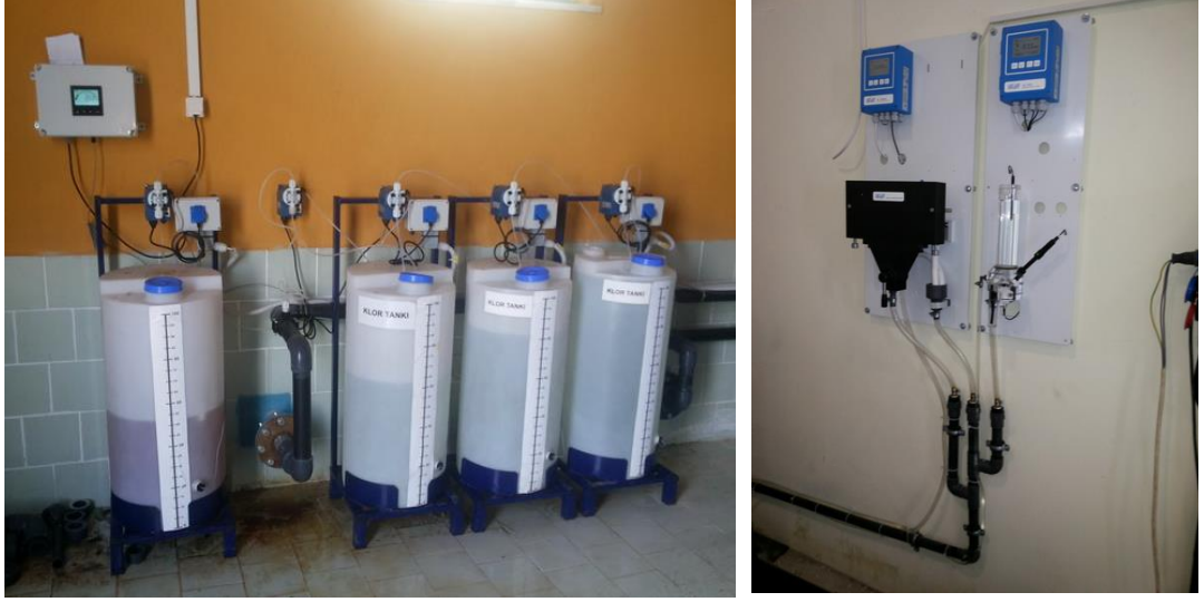
Şekil 2.6. Şehir suyu klorlama sistemleri
