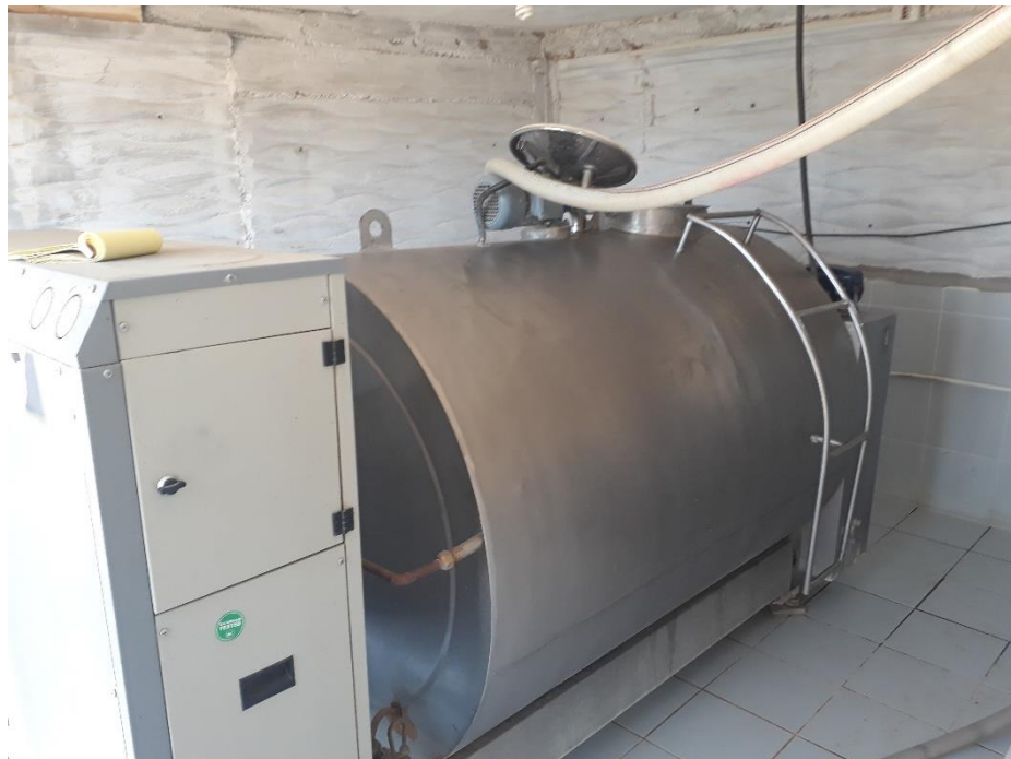
Şekil 4.18. Süt soğutma tankı bulunan bir işletme
