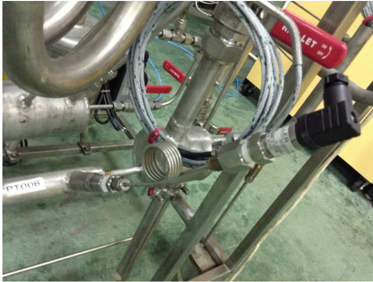
Şekil 4.24 : Deney tesisatında kullanılan basınç transmitteri.
