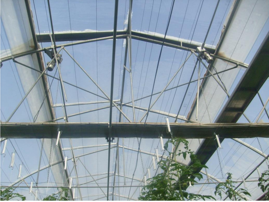
Şekil 4.22. Bir işletmeye ait serada çatıdaki havalandırma açıklıklarının elektrik motoruyla kontrolü (Cambazlı Köyü, Ahmetli)
