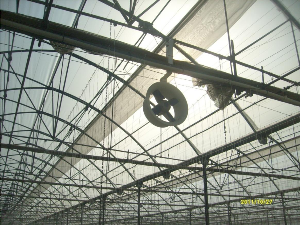
Şekil 4.23. Bir işletmeye ait serada mekanik havalandırma (Cambazlı köyü, Ahmetli)
