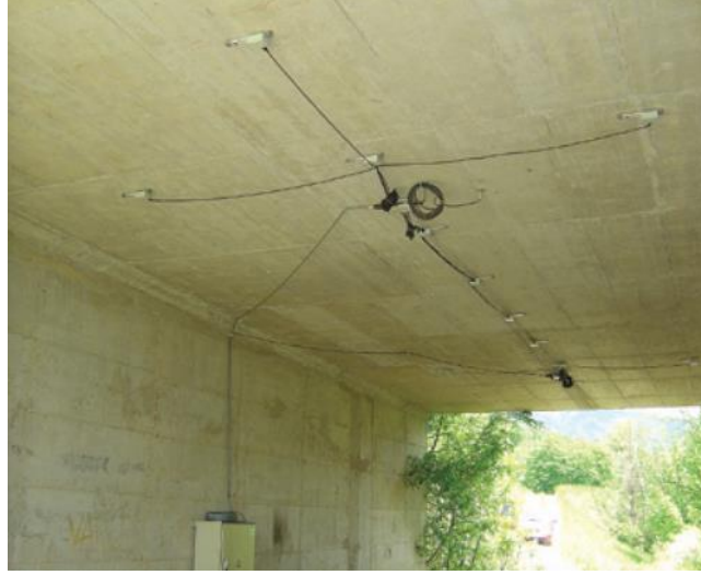
Şekil 2.5 Köprü Hareketli Ağırlık Ölçüm Sistemi (SiWIM Bridge WIM Systems,2013)
