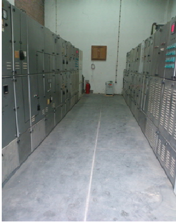
Resim 3.5 Alçak Gerilim Dağıtım Odası
