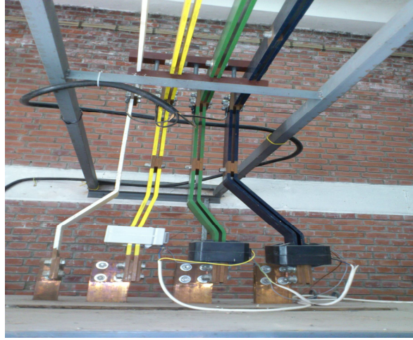
Resim 3.2 RGK’nin değer aldığı 3 adet akım trafosu
