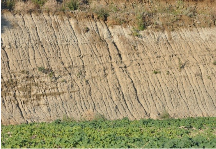
Foto 33. Çevreyolu Kenarındaki Erozyon İzleri
