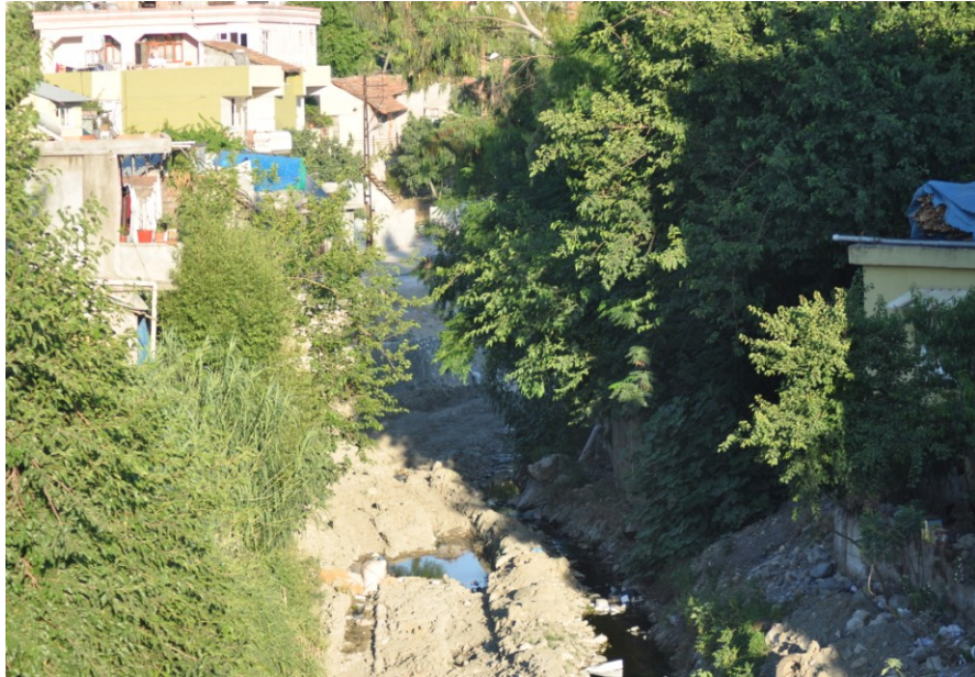
Foto 44. Altınçay Deresinin Yatağının Konutlar Tarafından İşgal Edilmesi
