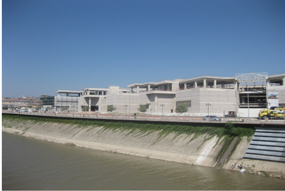
Foto 50. Asi Nehri'nin Taşkın Yatağına Yapılan Antakya Alışveriş Merkezi İnşaatı (Haraparası Mahallesi)
