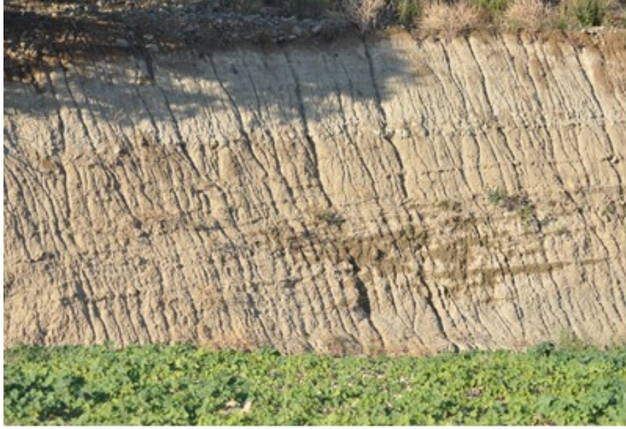
Foto 32. Çevreyolu Kenarındaki Erozyon İzleri
