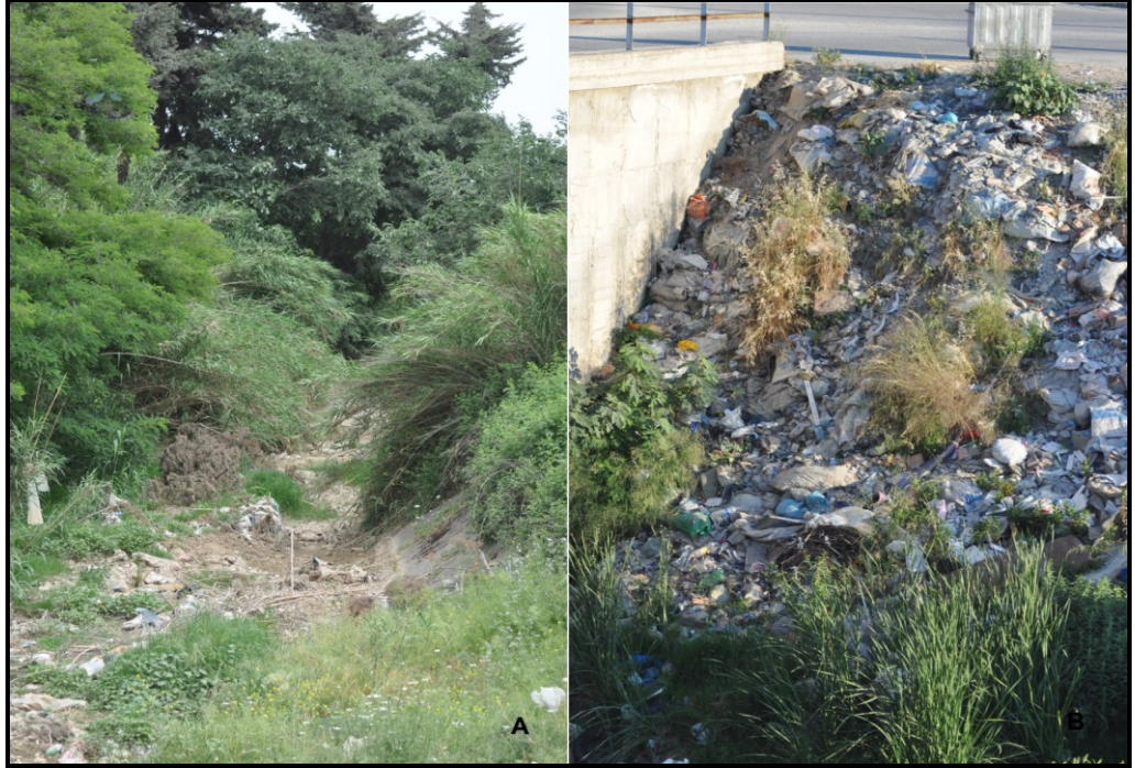
Foto 47. Hacı Kuriş (A) ve Altınçay (B) Dereleri’nin Yataklarının Atılan Çöpler ve Yabani Otlar Tarafından İşgal Edilmesi
