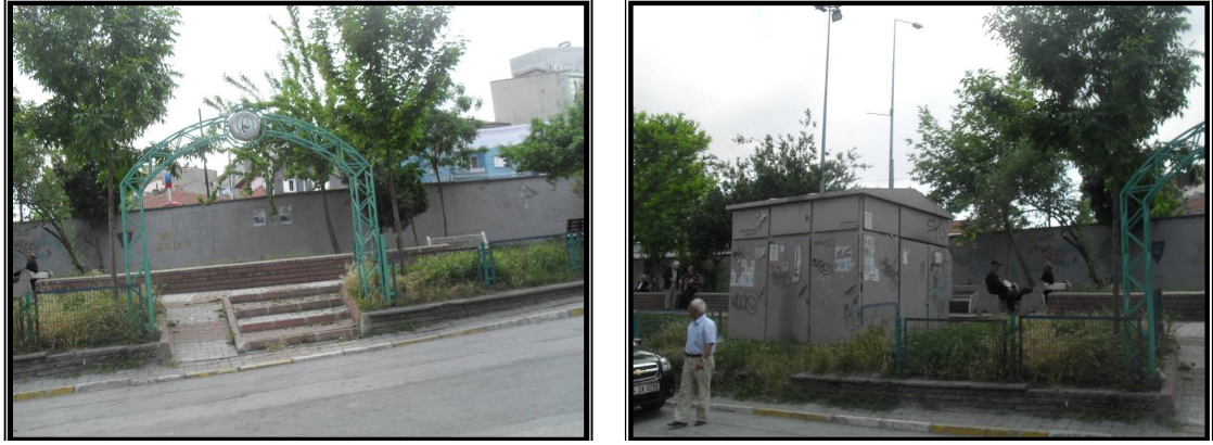
Şekil 4.84: 1- 1 Sokak Parkı'nın girişi. 2- 1 Sokak Parkı'nın içinde bulunan trafo (FINDIK, 2010).
