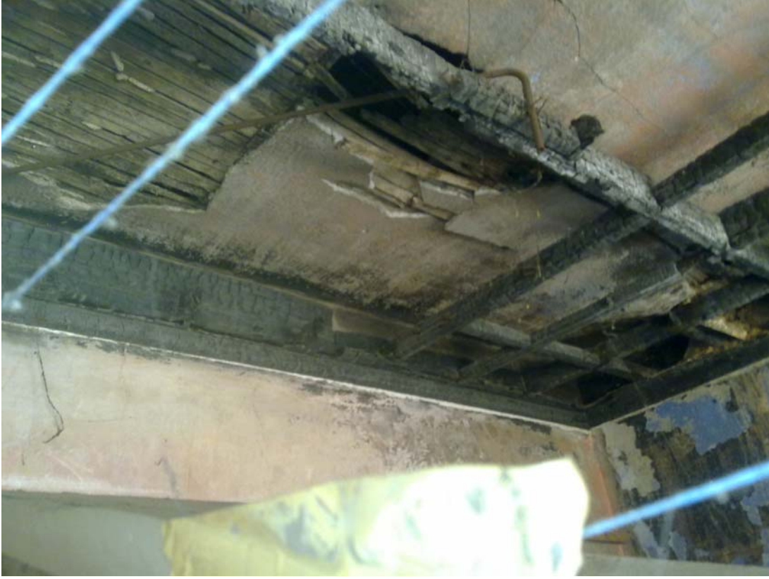
Şekil B.69 : 106 (Müdür Odası) mekânındaki yanmış tavan kaplaması
