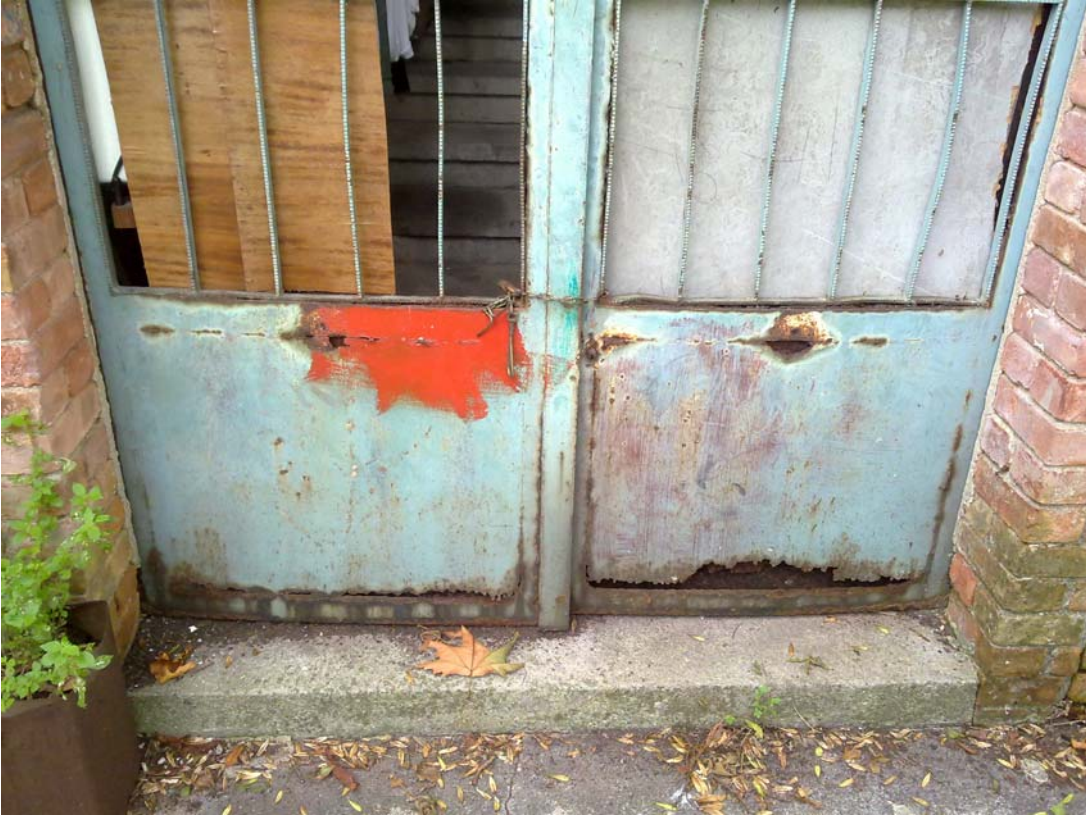
Şekil B.197 : Demir kapıda korozyon
