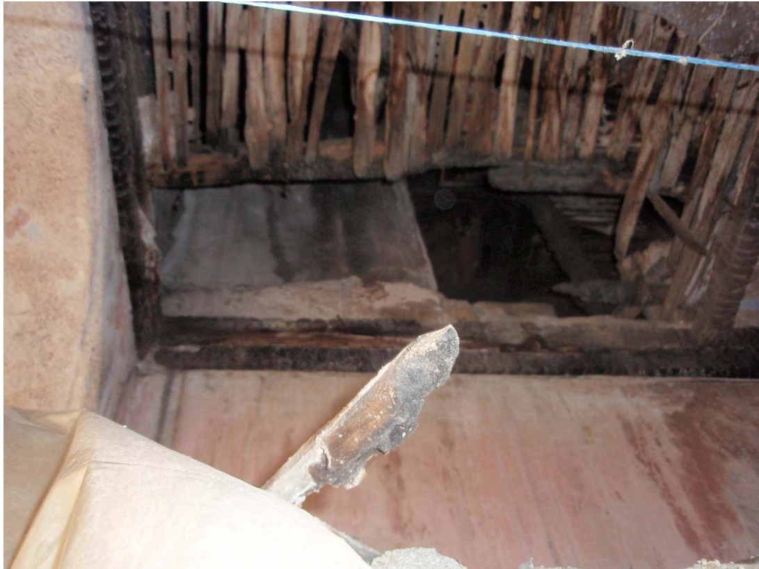
Şekil B.70 : 106 (Müdür Odası) mekânındaki yanmış tavan kaplaması
