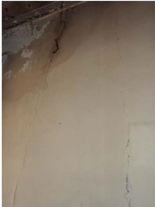
Şekil B.65 : 105 Mekânı güney duvarındaki çatlak izleri
