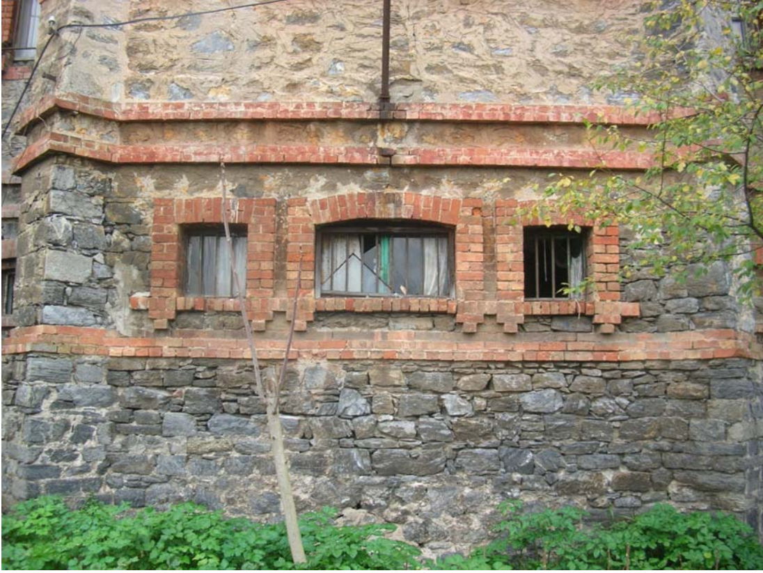
Şekil B.187 : Dođu cephesindeki tař yseylerde ařınma, derzlerde bořalma, yzey kirliliđi ve kırık camlar
