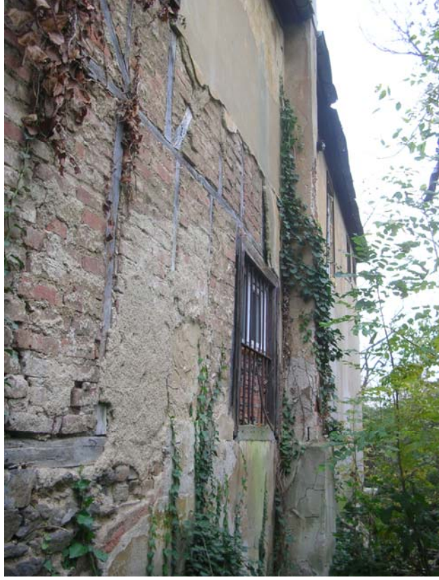
Şekil B.124 : Batı cephesinde sökülmüş sıva izleri
