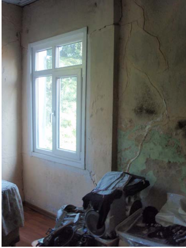
Şekil B.180 : 202 (Yatak Odası) mekânında strüktürel çatlaklar
