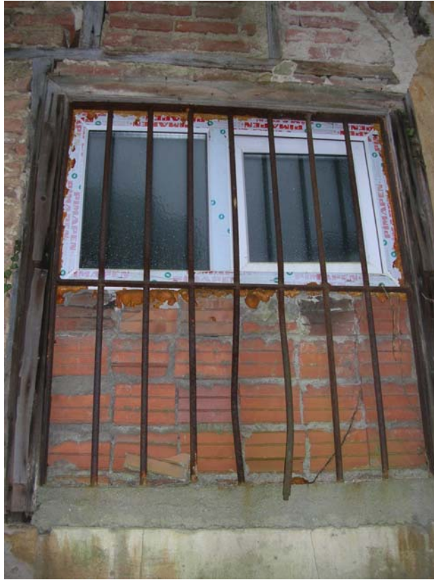
Şekil B.127 : Batı cephesinde kapatılmış pencere
