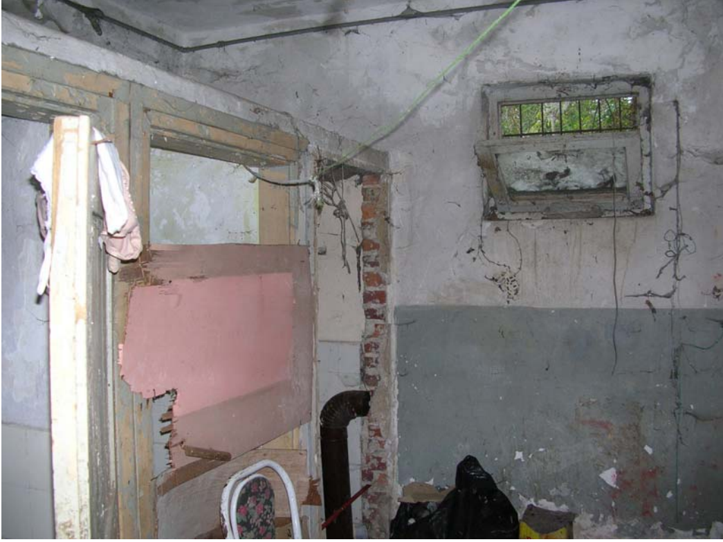
Şekil B.31 : Z07 Mekânı (Wc) doğu duvarı tuvalet kabinleri.
