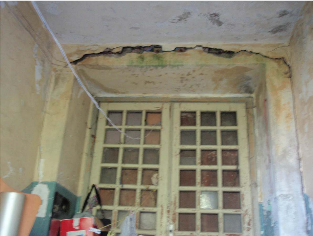
Şekil B.49 : 101 (Giriş) mekânındaki strüktürel çatlak.
