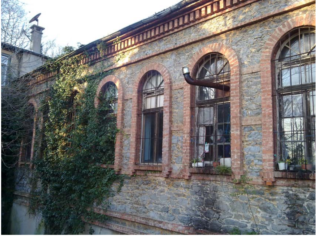
Şekil B.170 : Güney cephesindeki tahribat ve bitki oluşumu
