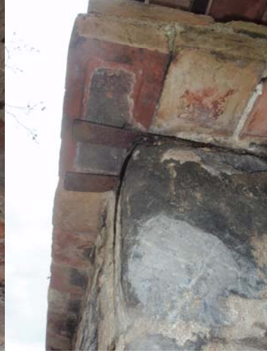
Şekil B.152 : Tuğlaları alttan destekleyen Demir elemanlar
