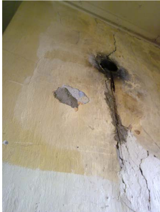
Şekil B.60 : 104 Mekânı (Gardrop) kuzey duvarındaki çatlak izi
