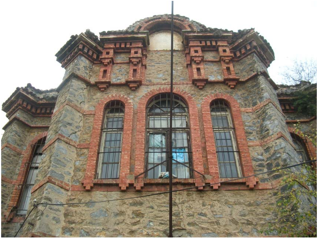
Şekil B.181 : Doğu cephesinde strüktürel çatlak
