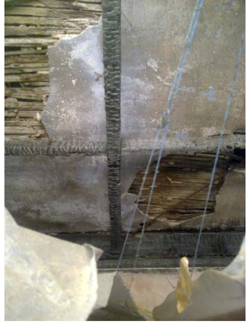
Şekil B.68 : 106 (Müdür Odası) mekânındaki yanmış tavan kaplaması
