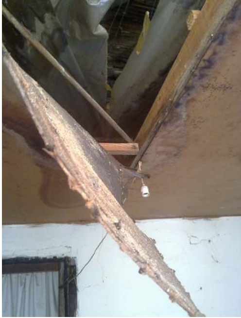
Şekil B.67 : 106 (Müdür Odası) mekânının harap olmuş tavan kaplaması
