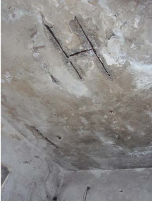
Şekil B.182 : Z07 (Wc) mekânının su alan tavanı
