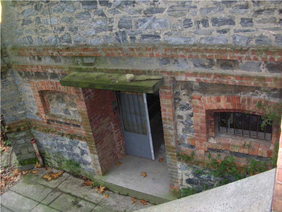
Şekil B.193 : Betonarme saçakta yosun oluşumu ve yüzey kirliliği
