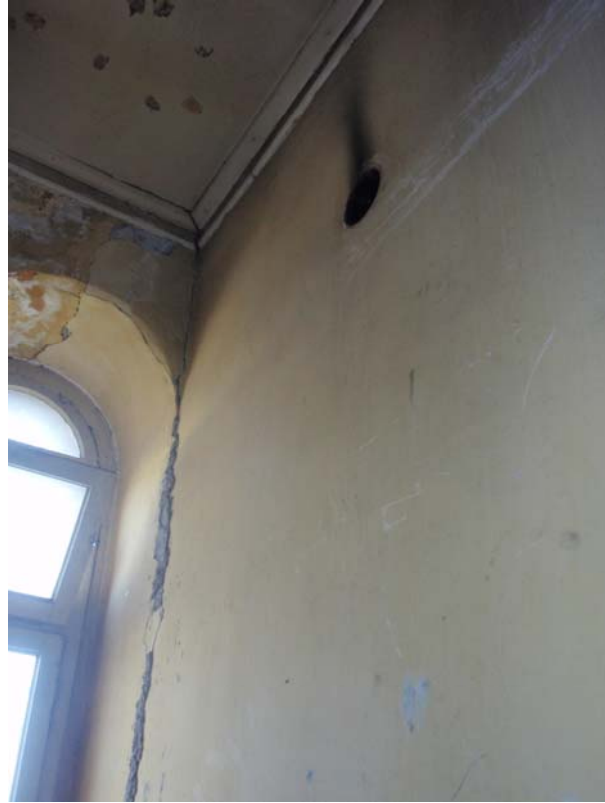
Şekil B.179 : 104 (Gardrop) mekânında strüktürel çatlak ve yapılan geçici onarım
