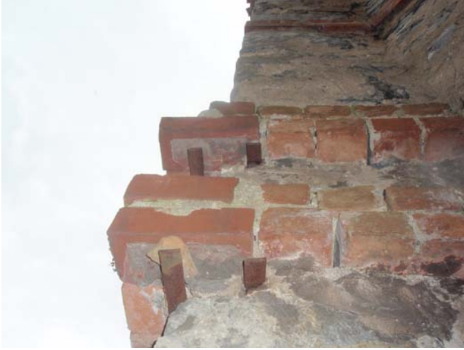
Şekil B.151 : Tuğlaları alttan destekleyen Demir elemanlar
