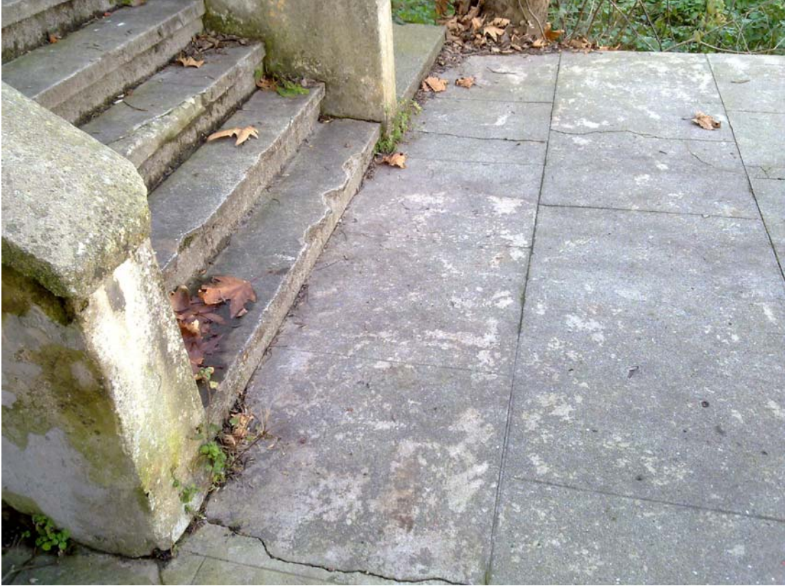
Şekil B.195 : Basamaklarda parça kopmaları ve çatlamış dökme beton
