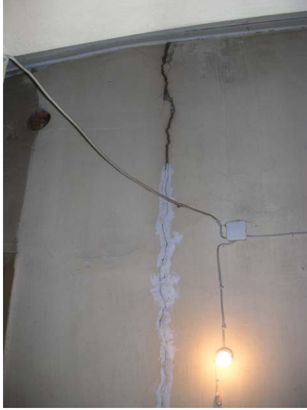
Şekil B.178 : 111 (Hol) mekânında strüktürel çatlak ve yapılan geçici Onarım
