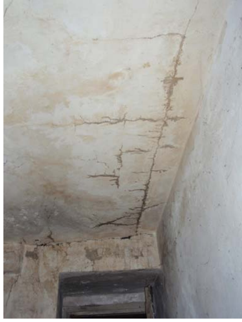
Şekil B.183 : Z07 (Wc) mekânının su alan tavanı
