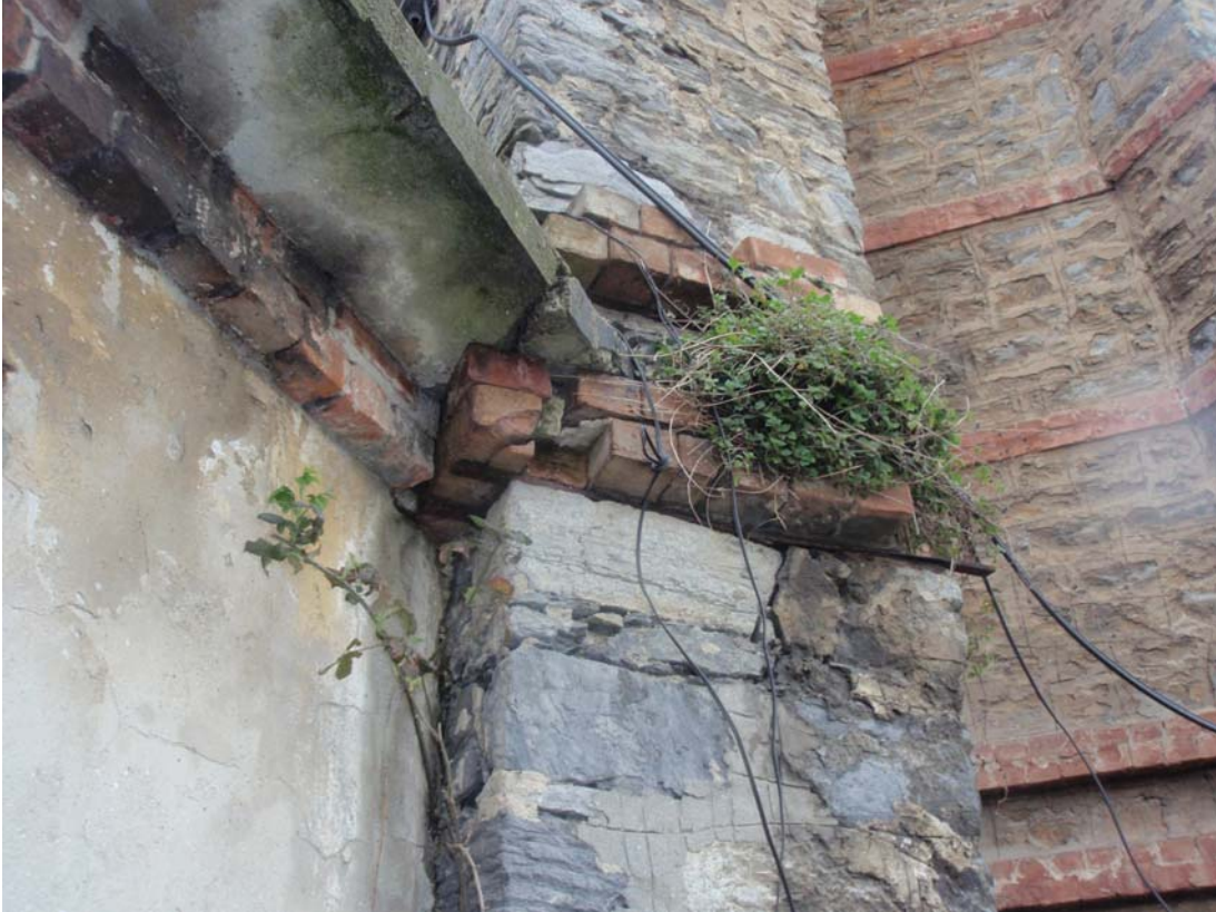
Şekil B.153 : Tuğlaları alttan destekleyen demir elemanlar ve parça kopmaları
