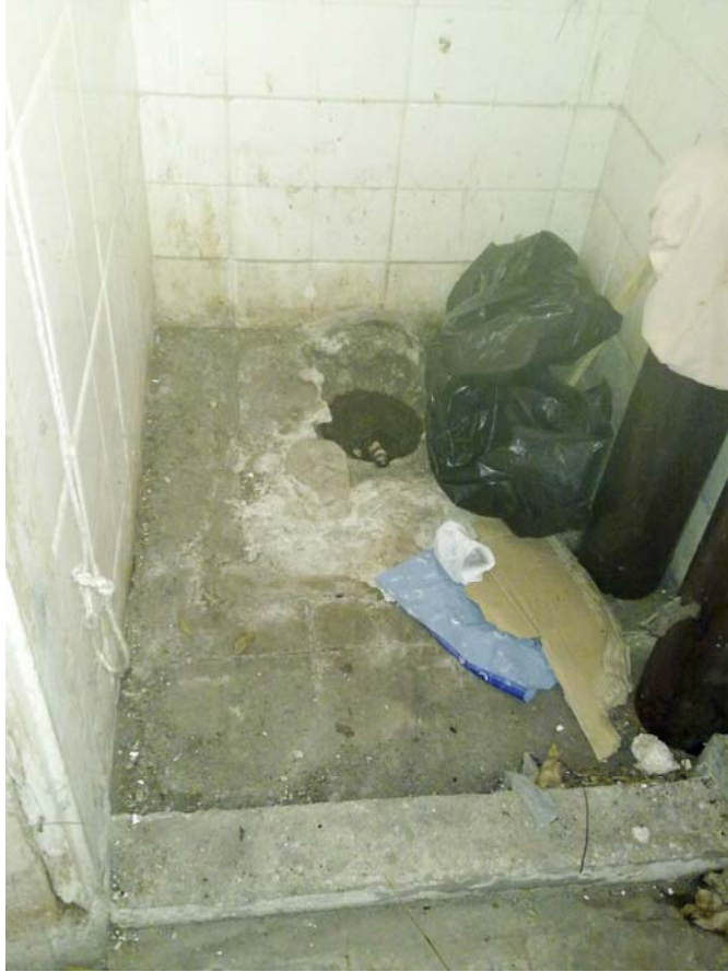
Şekil B.32 : Z07 (Wc) mekânındaki tahrip edilmiş tuvalet.
