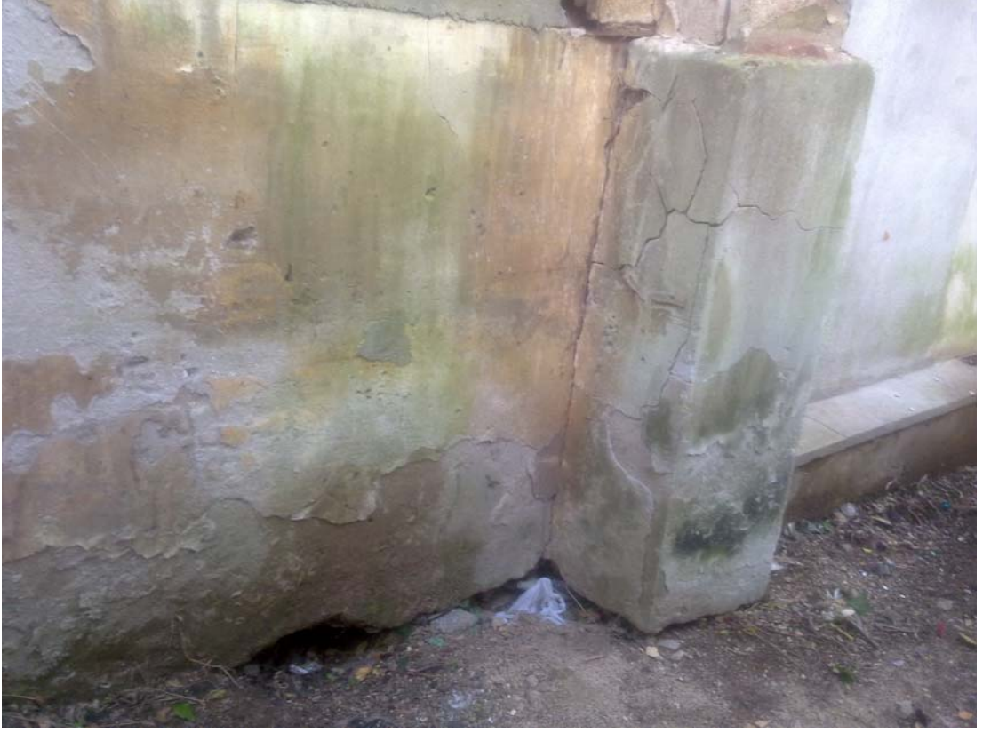
Şekil B.194 : Batı cephesinde bulunan oyuk/ delik, strüktürel çatlak ve kara yosunu
