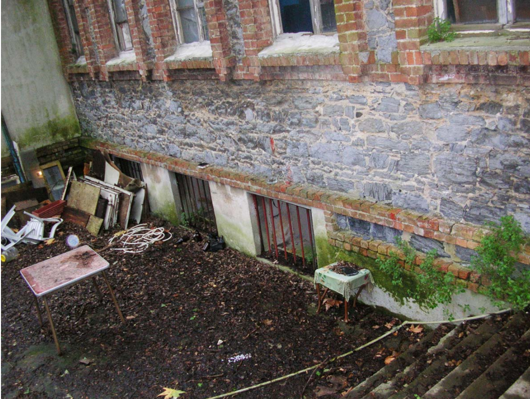
Şekil B.184 : Kuzey cephesinde yosun oluşumu ve bitkilenme
