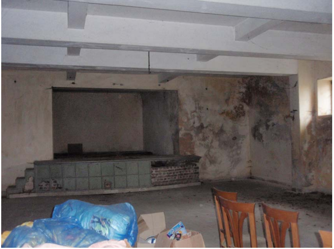
Şekil B.176 : Z02 (Yemekhane ve Tiyatro Salonu) mekânı duvarlarında sıva kabarması, sıva dökülmesi ve çiçeklenme
