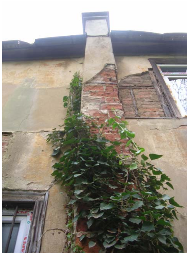
Şekil B.125 : Batı cephesinde sökülmüş sıva izleri
