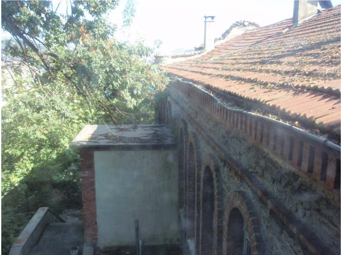
Şekil B.191 : Çinko yağmur oluklarındaki tahribat
