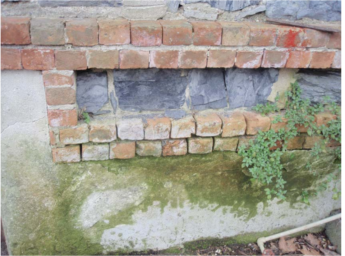
Şekil B.186 : Kuzey cephesinde yosun oluşumu ve derzlerde boşalma
