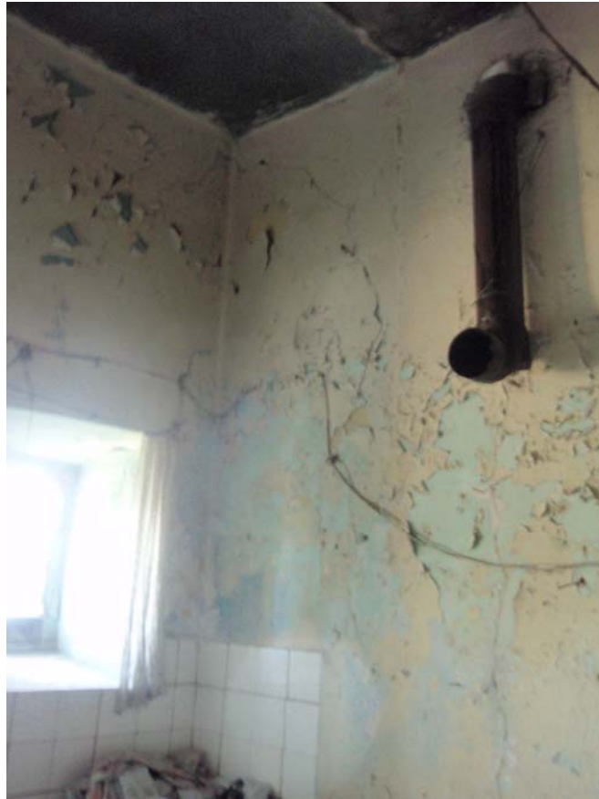
Şekil B.26 : Z05 (Mutfak) mekânında görülen kuzine borusu.
