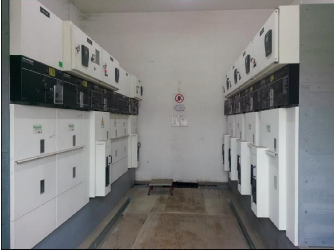
Şekil 5.1: A fabrikası ana og dağıtım odası.
