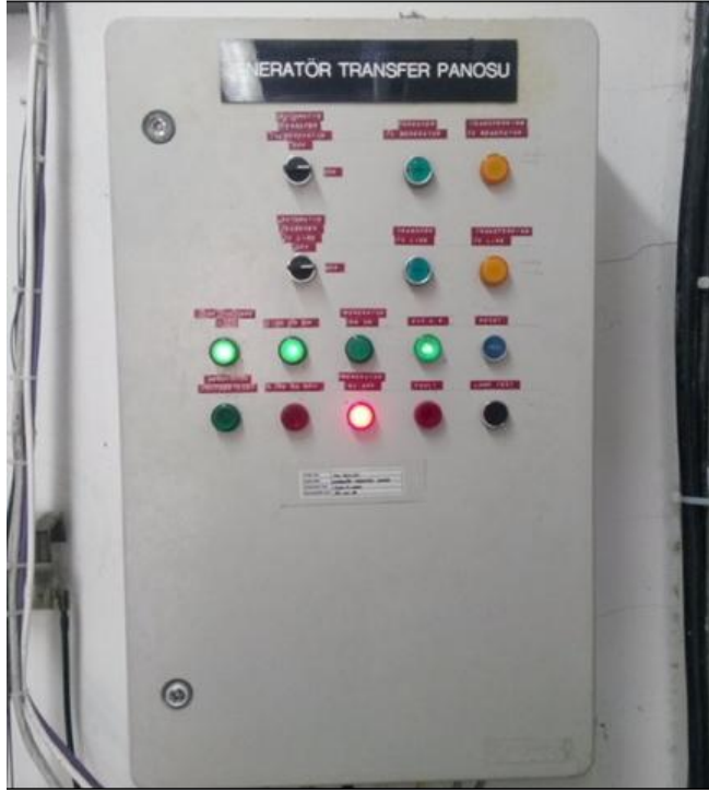
Şekil 5.7 : Generatör transfer panosu.
