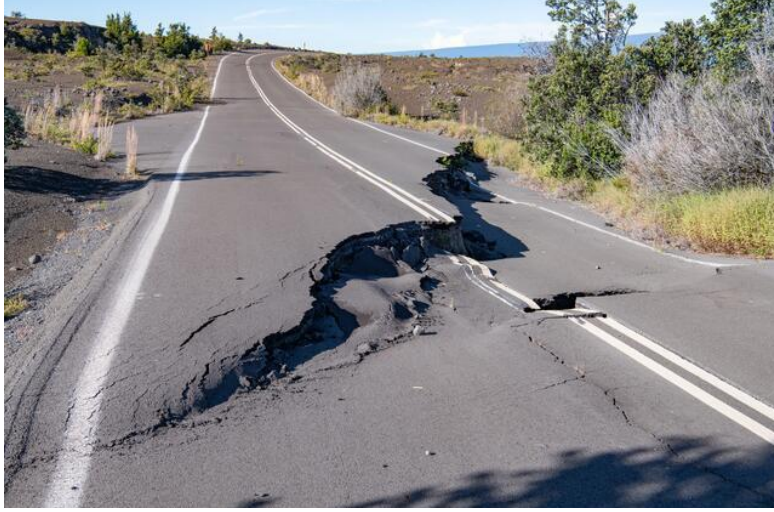
Şekil 112. Hawaii depremi hasarları (alamy.com, 2024)
