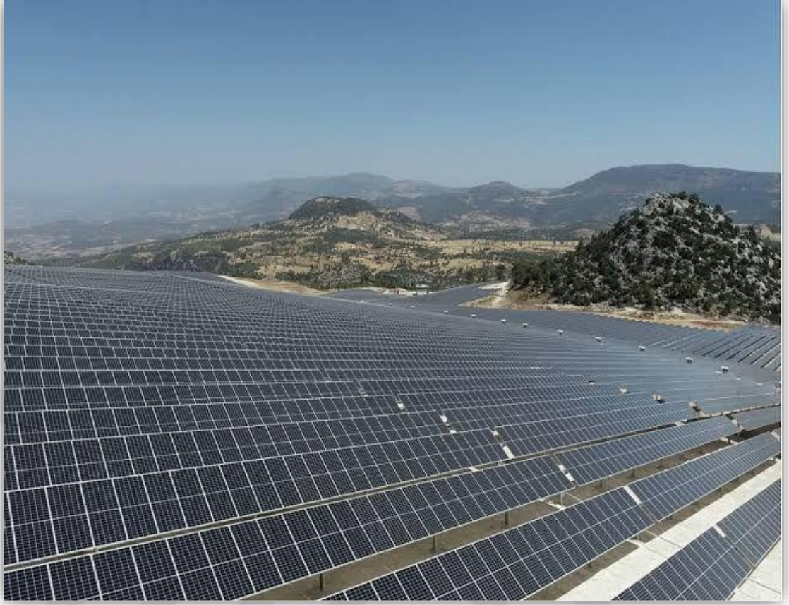
Şekil 4.18. Ceyhan ilçesinin Gündoğan Mahallesi'ndeki Gündoğan Güneş Enerji Santralleri
