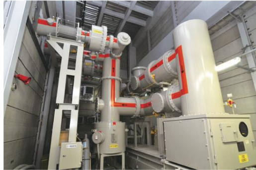
Şekil 2.11: Gaz izoleli bir trafo merkezi [18].
