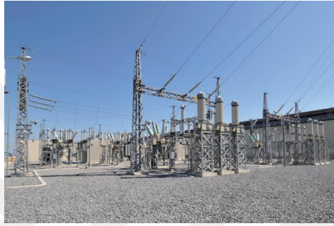
Şekil 2.10: Hava izoleli bir trafo merkezi [18].
