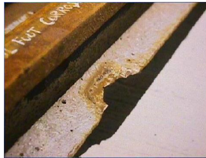
Şekil 2.50: Raylarda ve metal iletkenlerde korozyon ve demir kayıpları [2].
