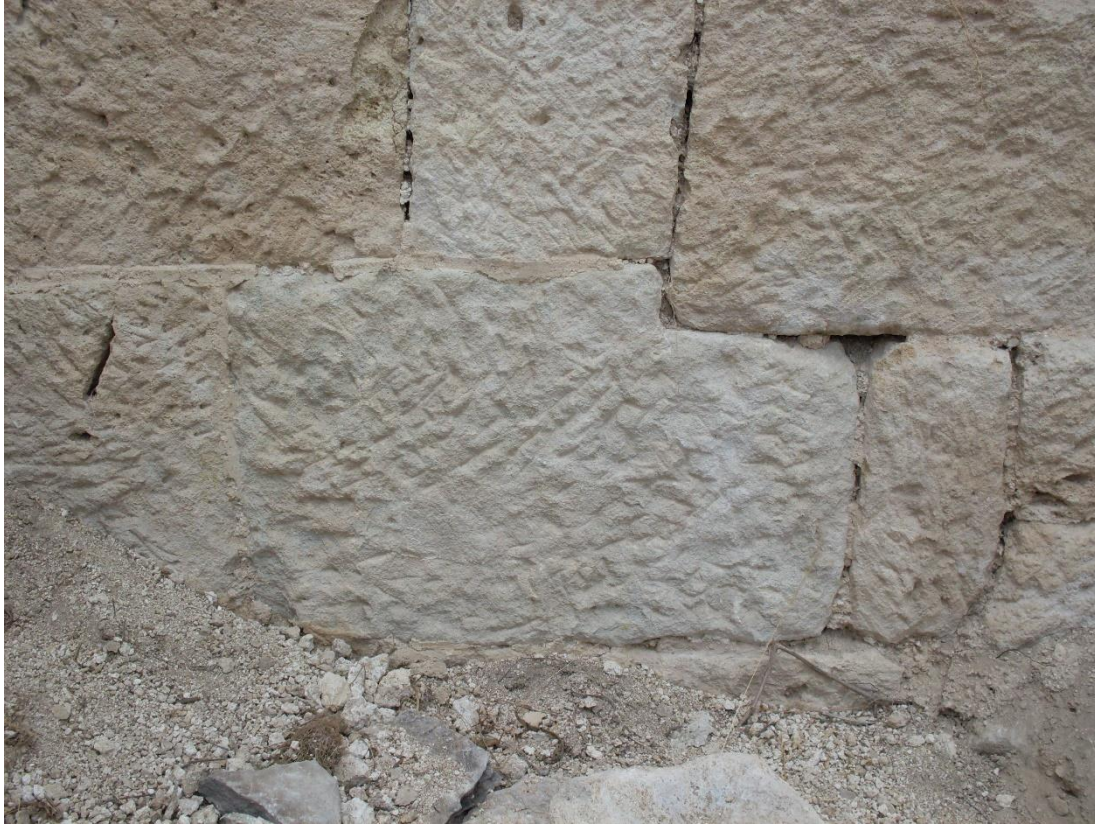
Şekil 3.21 : Zenonopolis Kilisesi kuzey duvarında bloklar üzerinde görülen girintiler (Saner, 2009).
