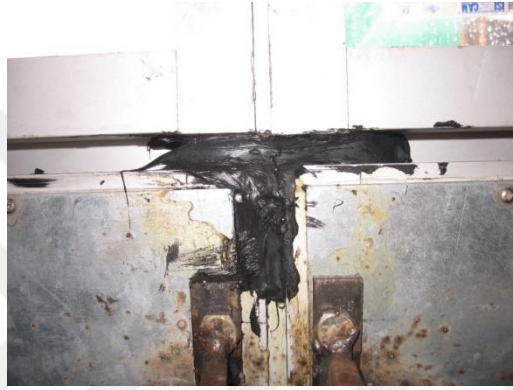
Şekil 5.17 Panel birleşiminde su girişi.
