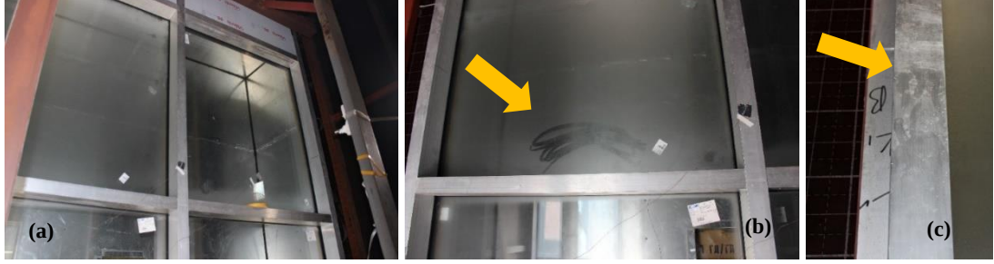
Şekil 5.26 Çubuk sistemde ısıl döngü testinde yoğuşma oluşumu (a), cam ünitesinde yoğuşma (b), düşey profilde yoğuşma (c).
