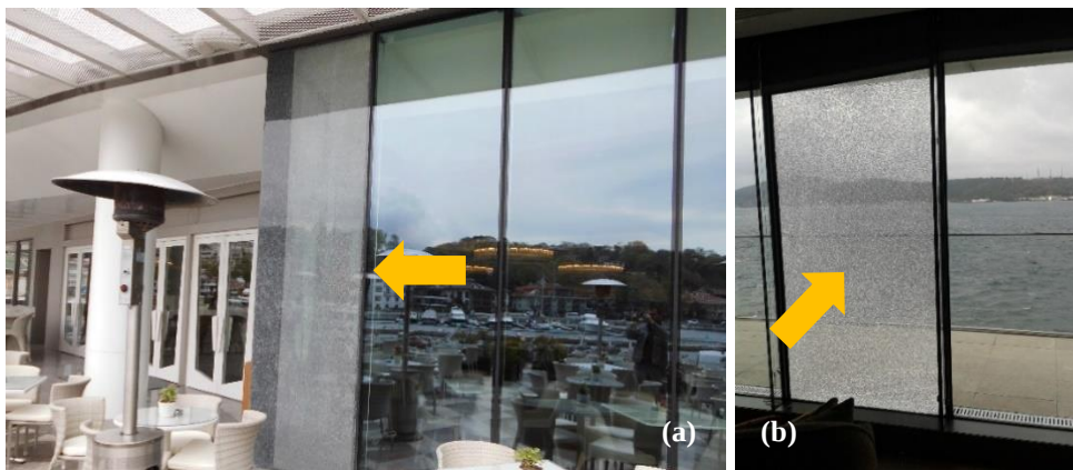
Şekil 3.5 Bina oturması nedeniyle camda oluşan kırılmalar (a) ve (b).
