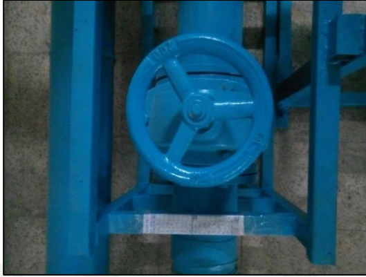
Şekil 2.4. Kanal Giriş Vanası
