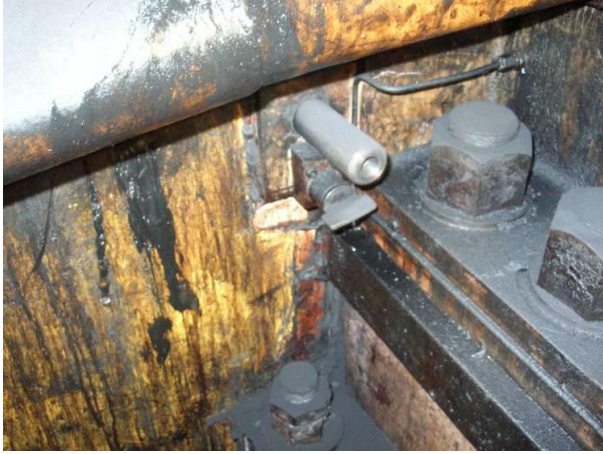
Resim 3.3. Castell anahtarı ile bunbury mikser de açık kapı bakım pozisyonu
