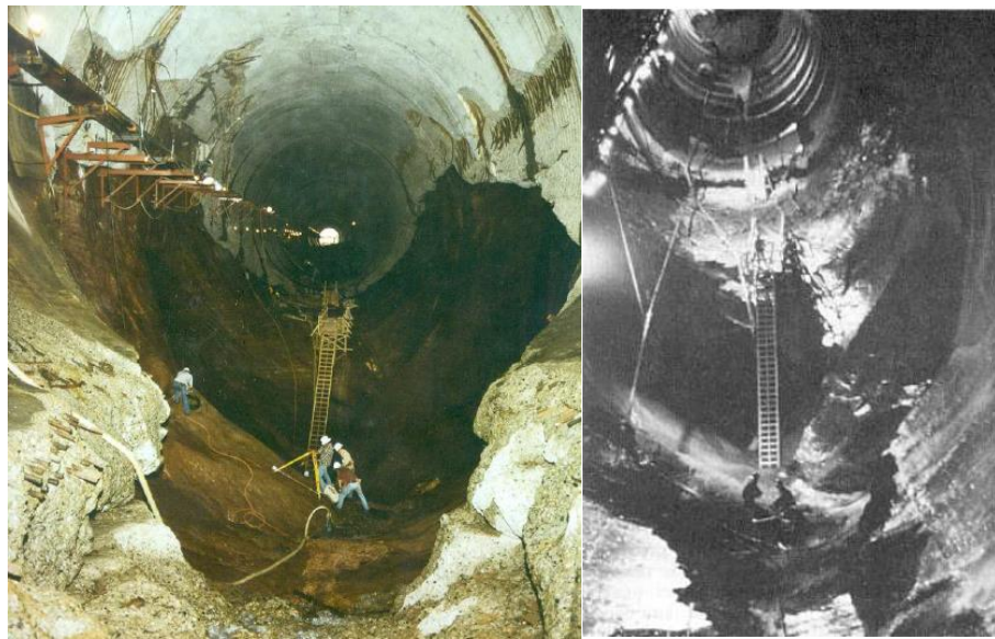
Şekil 2.4. Glen Kanyon Barajının tünel dolusavağının kavitasyon hasarı (Falvey, 1990)
