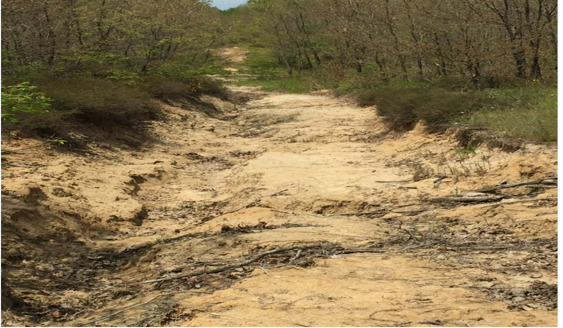
Şekil 5.11 Bozulmuş Dozer Yolu Görünüm [11]
