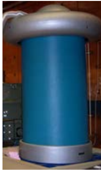
Şekil 4.3 : 50 Hz, 175 kVA, 0,5/350 kV' luk deney transformatörü.
