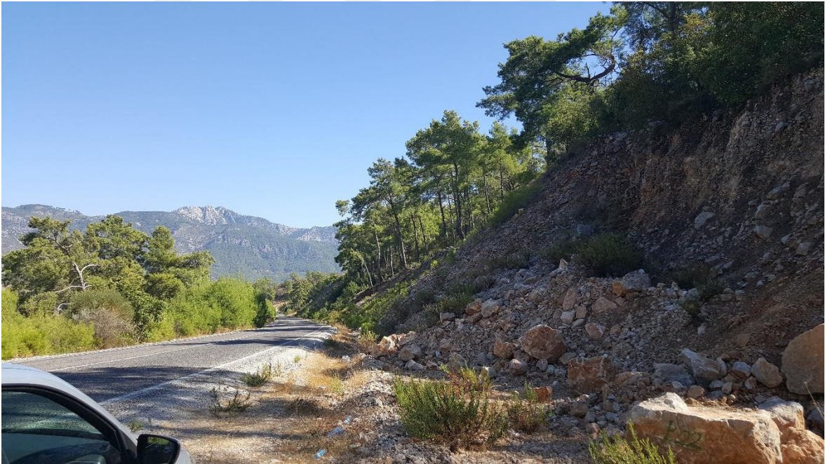
Şekil 3.3. Adrasan ve çevresinde yol kesmesi sonucu gelişen heyelanlarda ağaçların aşağı doğru yönelimine ait örnek fotoğraf
