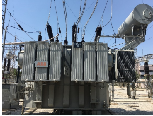
Şekil 2.2: 50 MVA gücündeki bir transformatörün genel görünüşü
