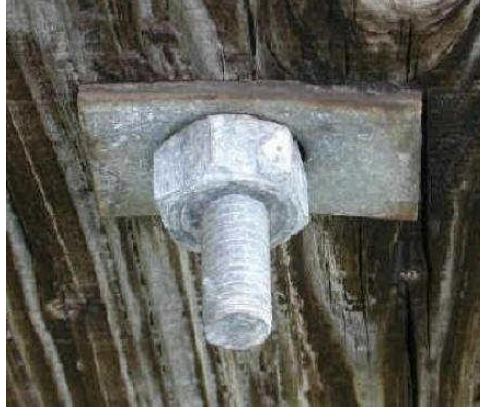
Şekil 2.10. Farklı metaller arasında oluşan galvanik korozyon (Anonim 2009)
