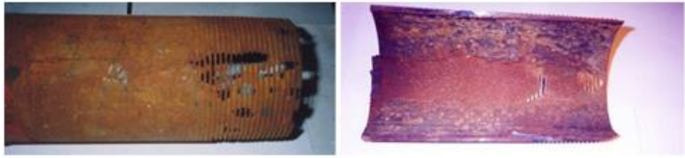
Şekil 2.13. Borunun dış ve iç görünümü ile erozyon korozyonu (Anonim 2009).
