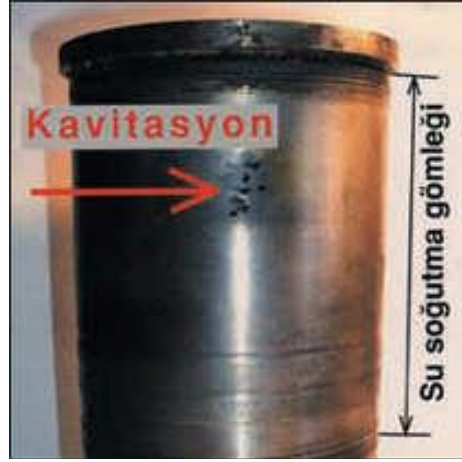
Şekil 2.16. Kavitasyonun sebep olduğu korozyon görünümü (Anonim 2009)
