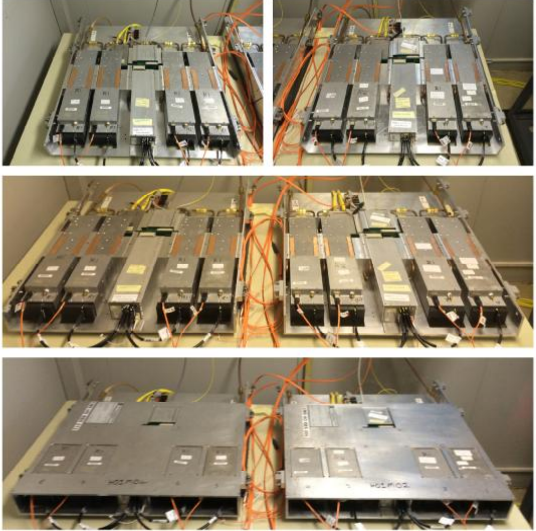
Şekil 4.1. SX5’de bulunan test düzeneğindeki RBX’lar ve içindeki elemanlar.
