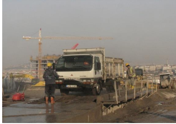
Şekil 4.33: Şantiye alanında hafriyat ve malzeme taşıyan kamyon lastiklerinin yıkanması.
