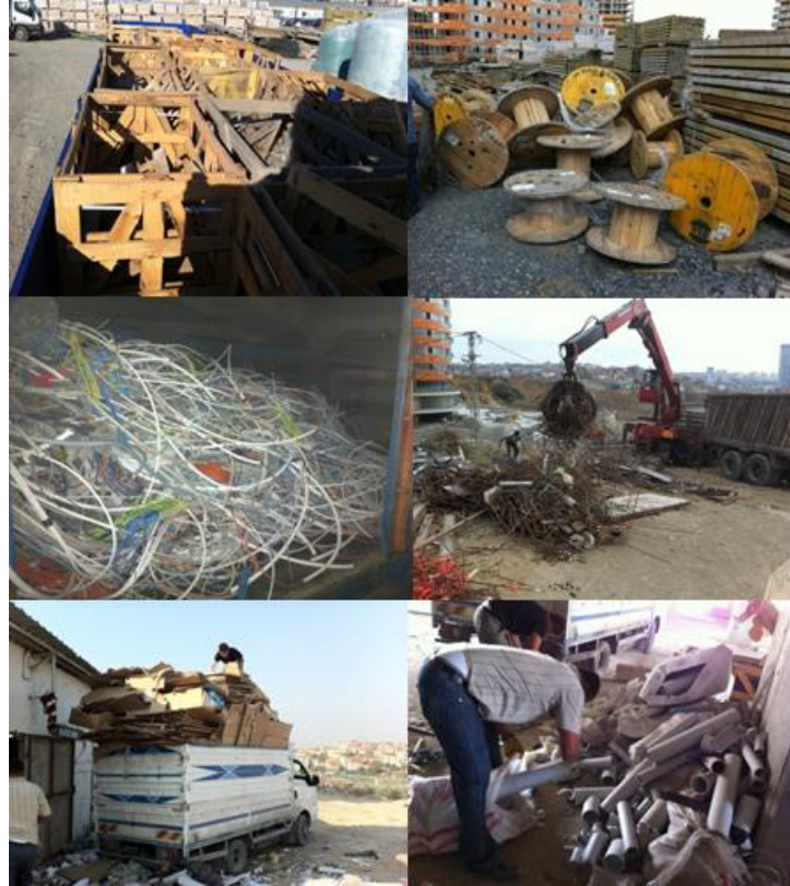
Şekil 4.39: Varyap Meridian Toplu Konut Alanı proje alanından toplanan çeşitli inşaat atıkları.
