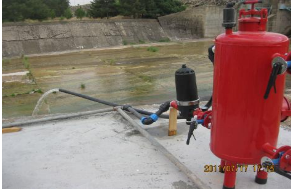
Resim 3.2. Su kaynağından sulama suyunun sisteme alınması ve sistem kontrol ünitesi
