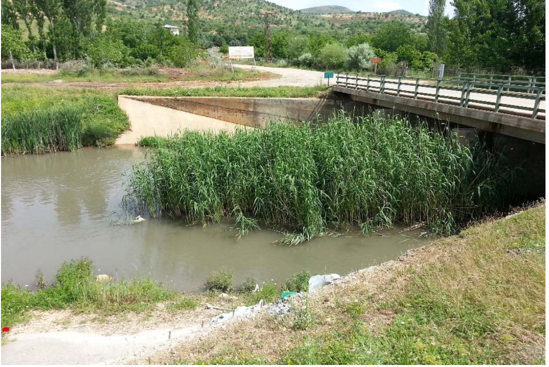
Şekil 4.6. Azaplı Kanal 1 istasyonu
