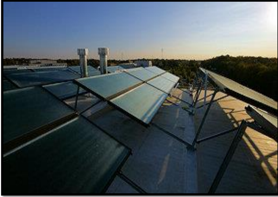
Şekil 3. 24 Proximity Hotel, çatıya monte edilen 100 adet güneş paneli [57]
