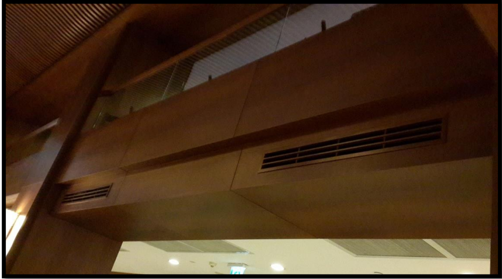
Şekil 5. 41 BW The President Otel lobi bölümü havalandırma
