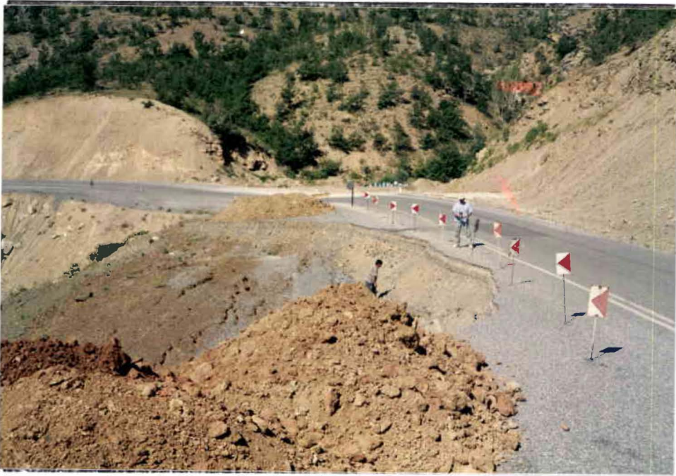
Foto 59: Taşkent'in girişindeki heyelandan bir başka görünüm. Heyelânın hemen gerisinde ve yol üzerinde görülen çukurlaşma, daha önce o kısmın da heyelâna maruz kaldığını gösteriyor.
