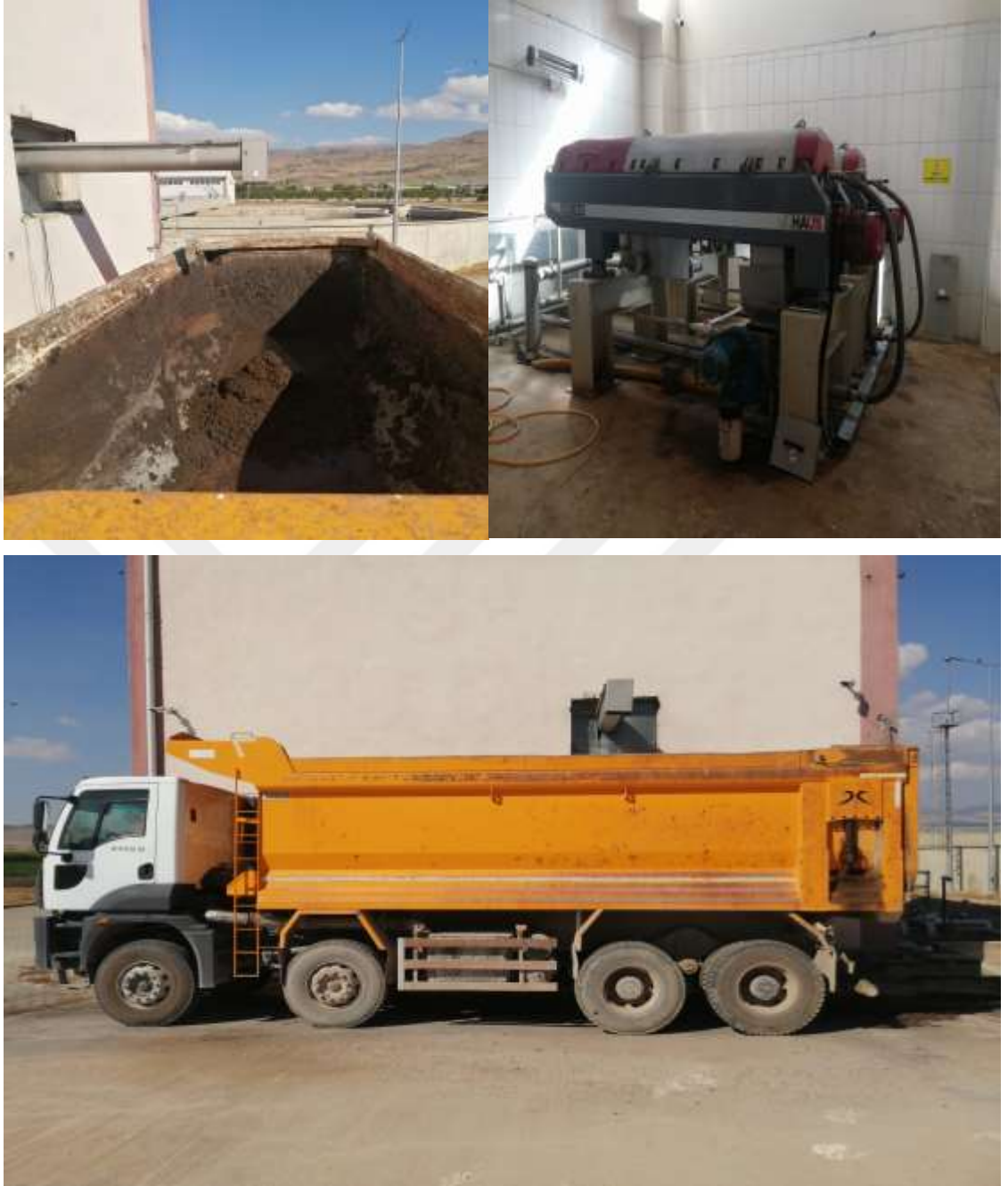
Şekil 4. Develi AAT Çamur Susuzlaştırma ve Dekantör Ünitesi
