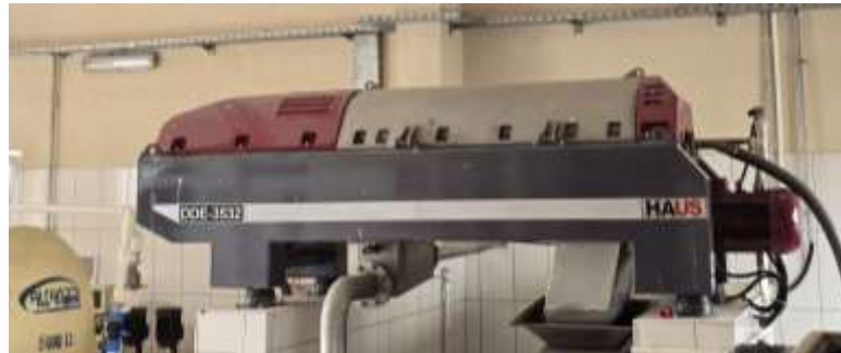
Şekil 8. Tomzarza AAT Çamur Susuzlaştırma ve Dekantör Ünitesi
