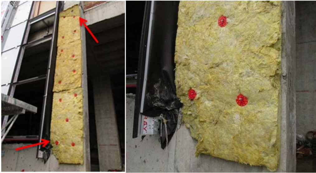
Şekil 5.24: Deforme olan taş yünü yalıtım malzemesi [30]
