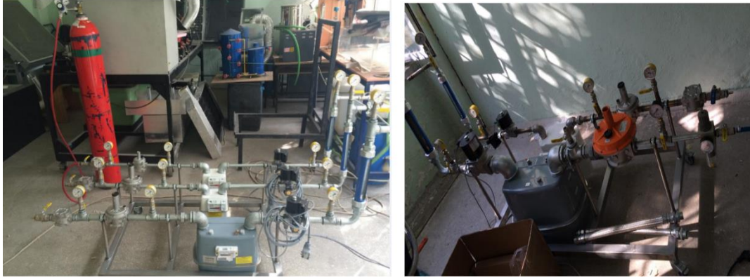
Resim 5.4. Gaz hattı ve bu hatlardaki armatürler ve Yakma havası hattı
