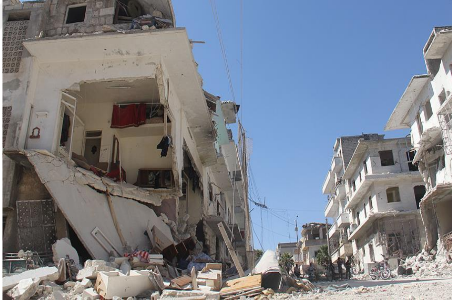
Şekil 1.3: İdlib'de bombalı saldırı sonucu döşemelerin tahribine örnek (Url-1) (AA, 2016)
