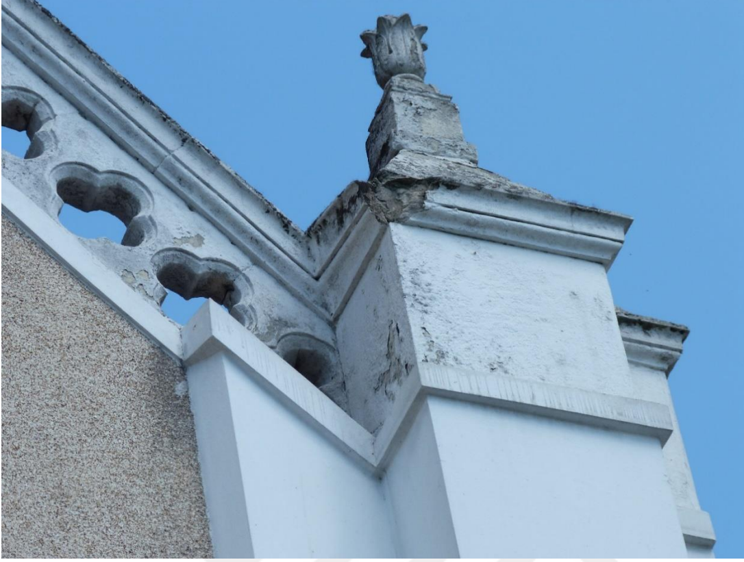
Şekil D.9 : Güneydoğu cephesi kule silme porfillerinde malzeme kaybı.
