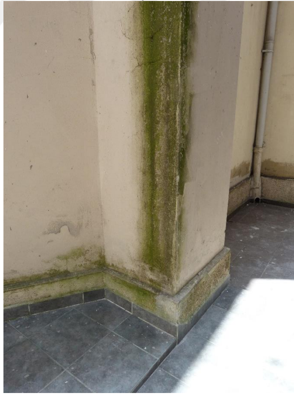
Şekil D.32 : Kuzeybatı cephesinde P4 plastırı hizasında biyolojik oluşumlar.
