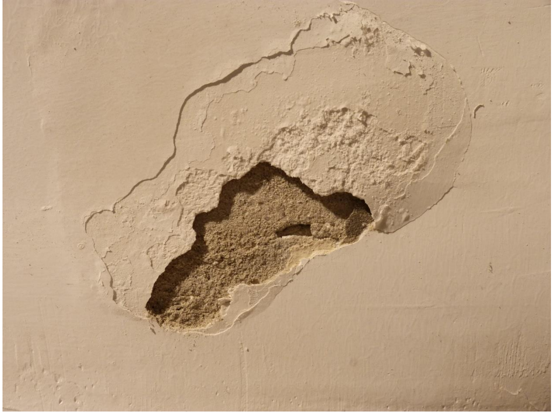
Şekil D.24 : Naos bölümü duvar yüzeylerinde tuzlanma.
