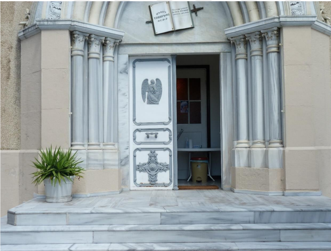
Şekil D.30 : Demir ana giriş kapısında korozyon.
