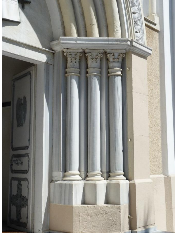
Şekil D.8 : K01 kodlu giriş kapısı üzerinde yer alan mermer yüzeyde çatlak.
