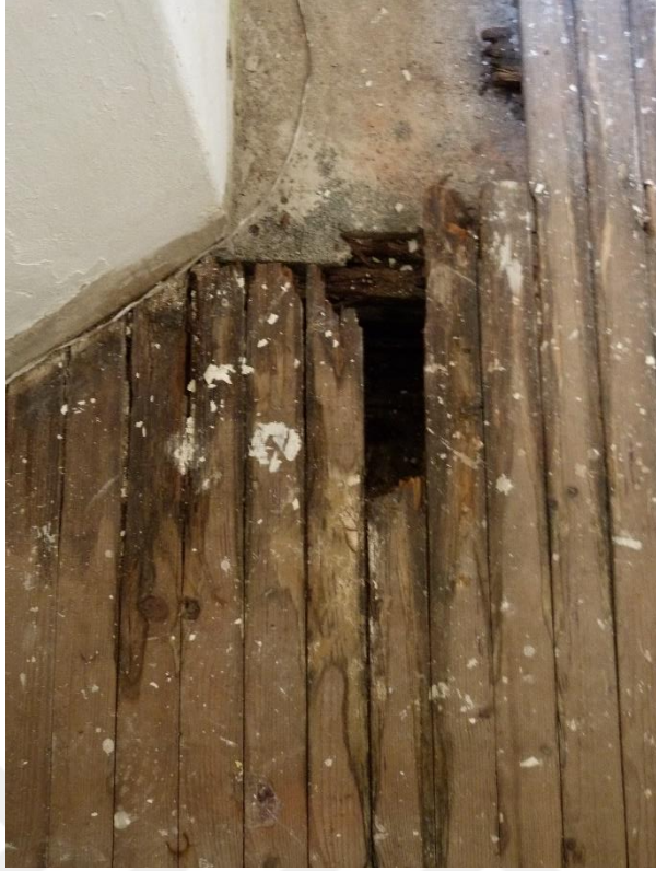
Şekil D.15 : K104 Oda 1 rabıta döşemesinde malzeme kaybı.
