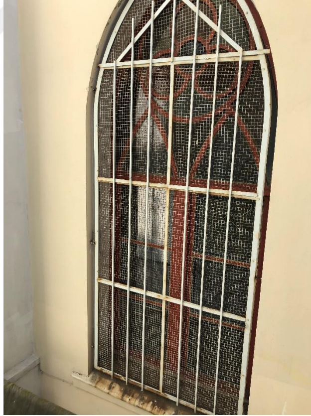
Şekil D.26 : Parmaklık korozyonu nedeniyle lekelenme.
