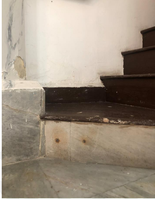
Şekil D.25 : M 01 merdiveni mermer kaplamalarında korozyon lekeleri.
