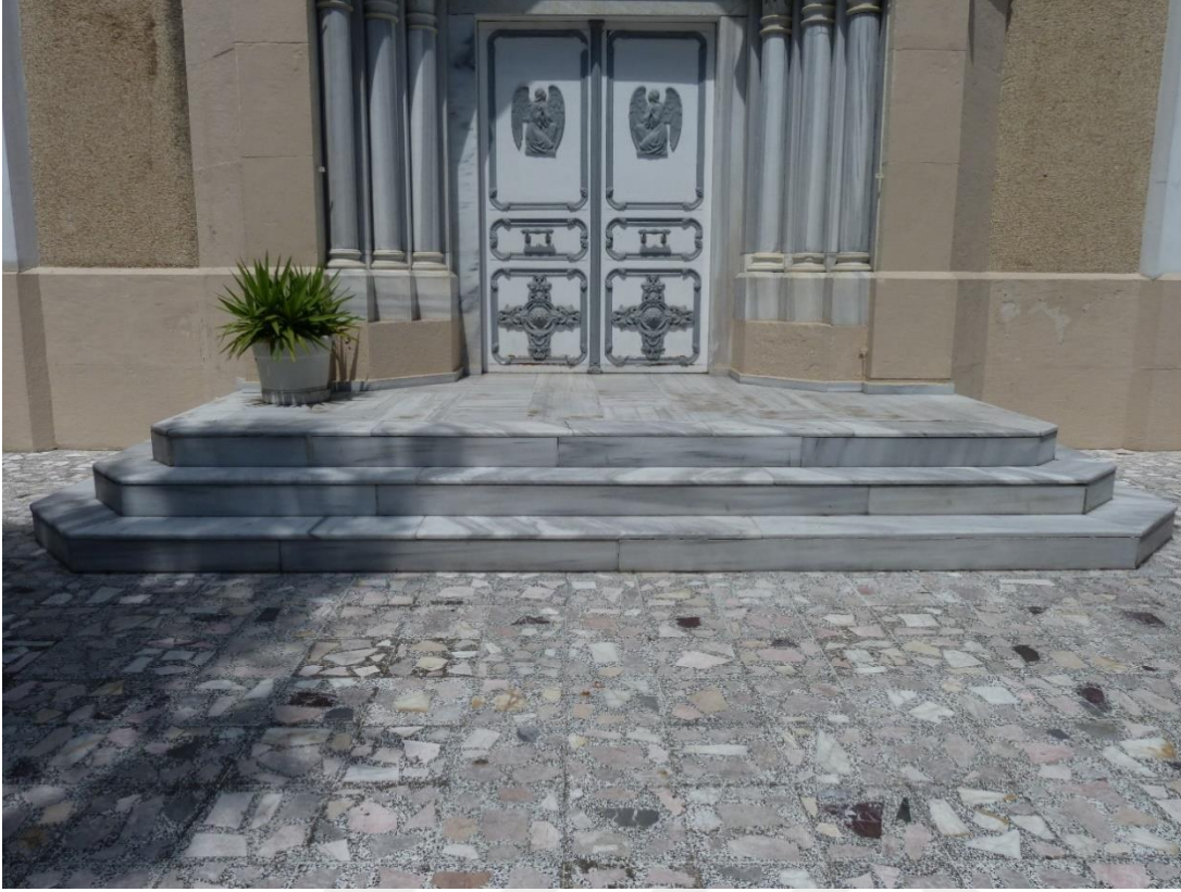
Şekil D.29 : Giriş mermer basamaklarında lekelenmeler
