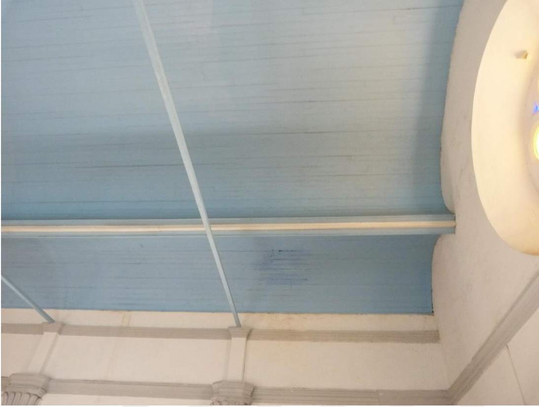
Şekil D.1 : Ahşap tonozda suya bağlı lekelenmeler.
