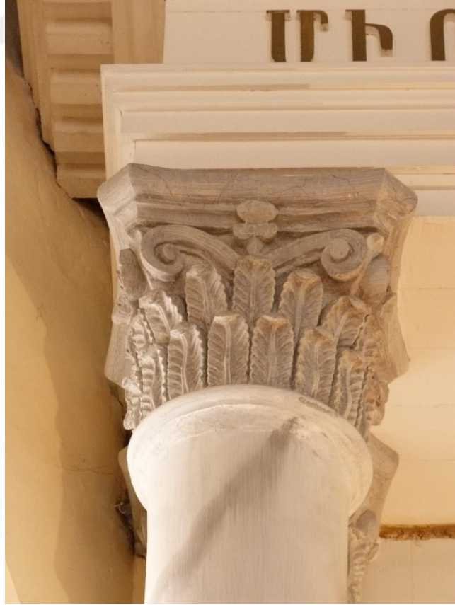
Şekil D.4 : Mermer sütun başlıklarında çatlaklar.
