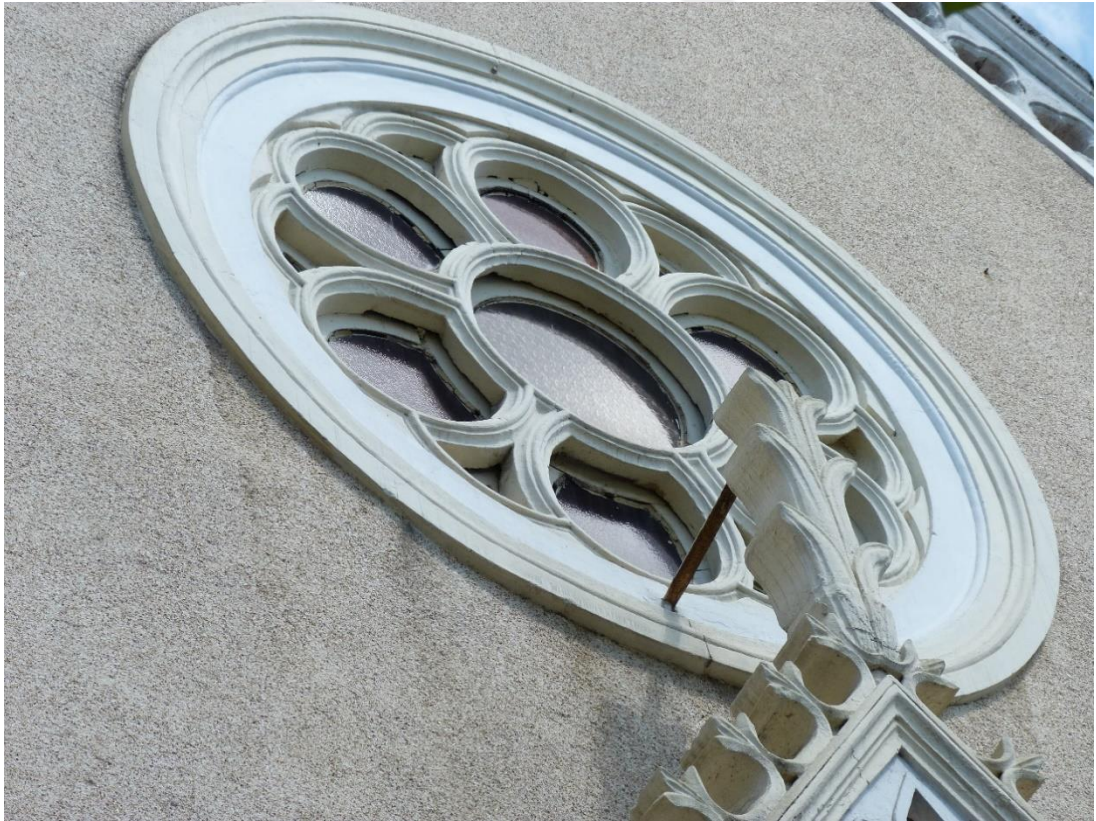
Şekil D.20 : Güneydoğu cephesinde gül pencere altında akma izleri.
