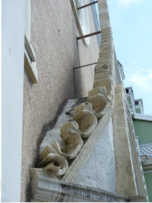
Şekil D.27 : Gotik alınlığını sabitleyen demir elemanlarda korozyon ve buna bağlı lekelenmeler.
