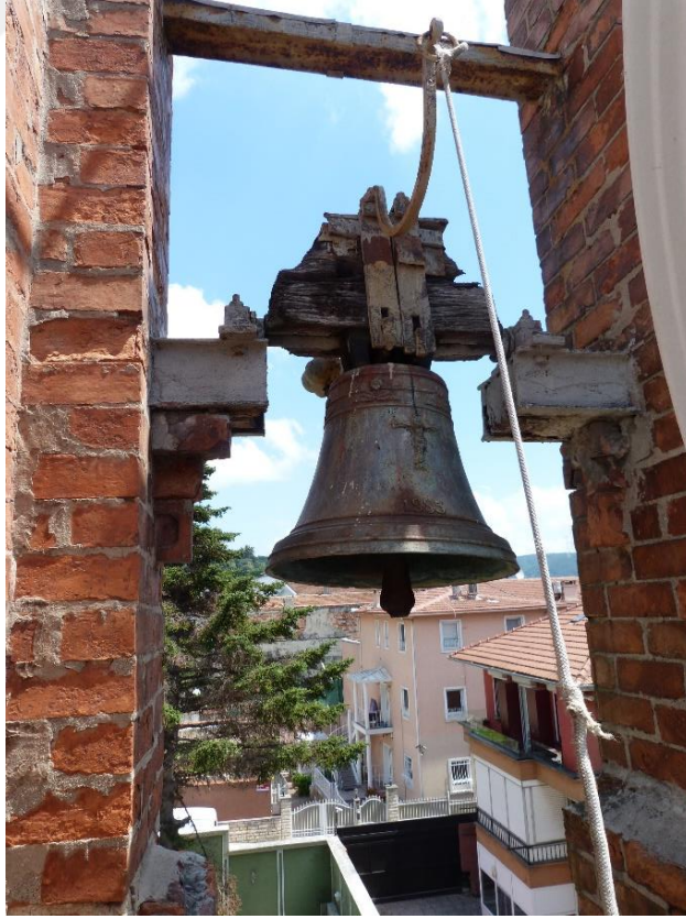
Şekil D.12 : Çan kulesinde malzeme ve yüzey kayıpları.
