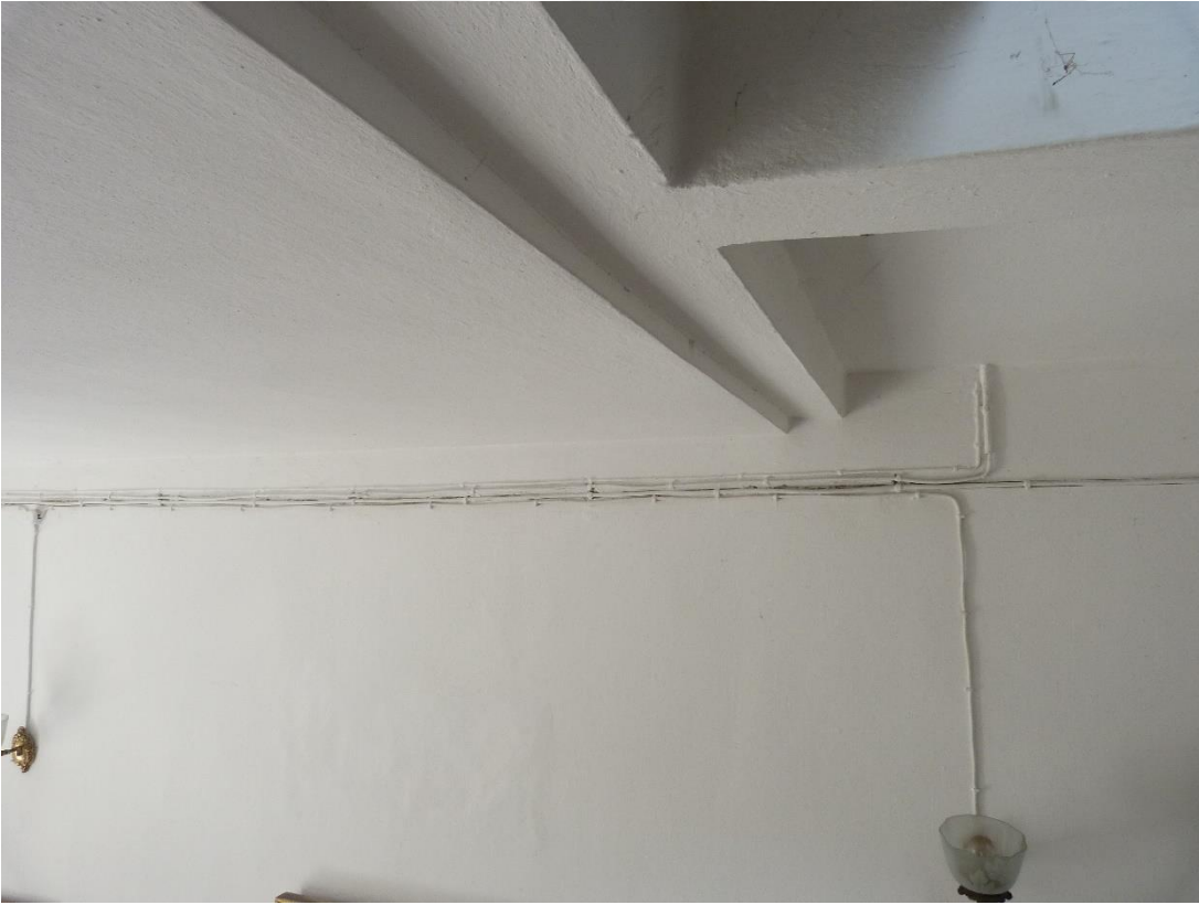
Şekil C.83 : ZK 05 Hol-1 mahallinde bulunan betonarme kırışler.
