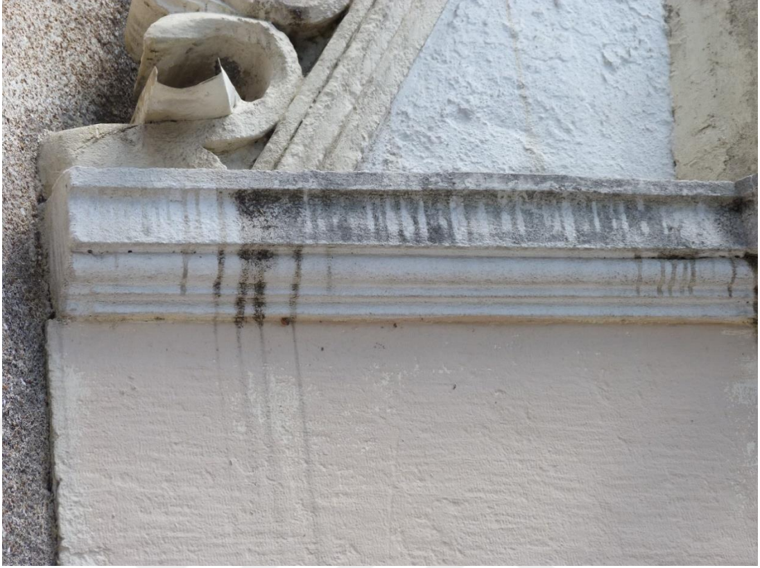
Şekil D.19 : Güneydoğu cephesi silmesinde gri-siyah renkli akma izi.
