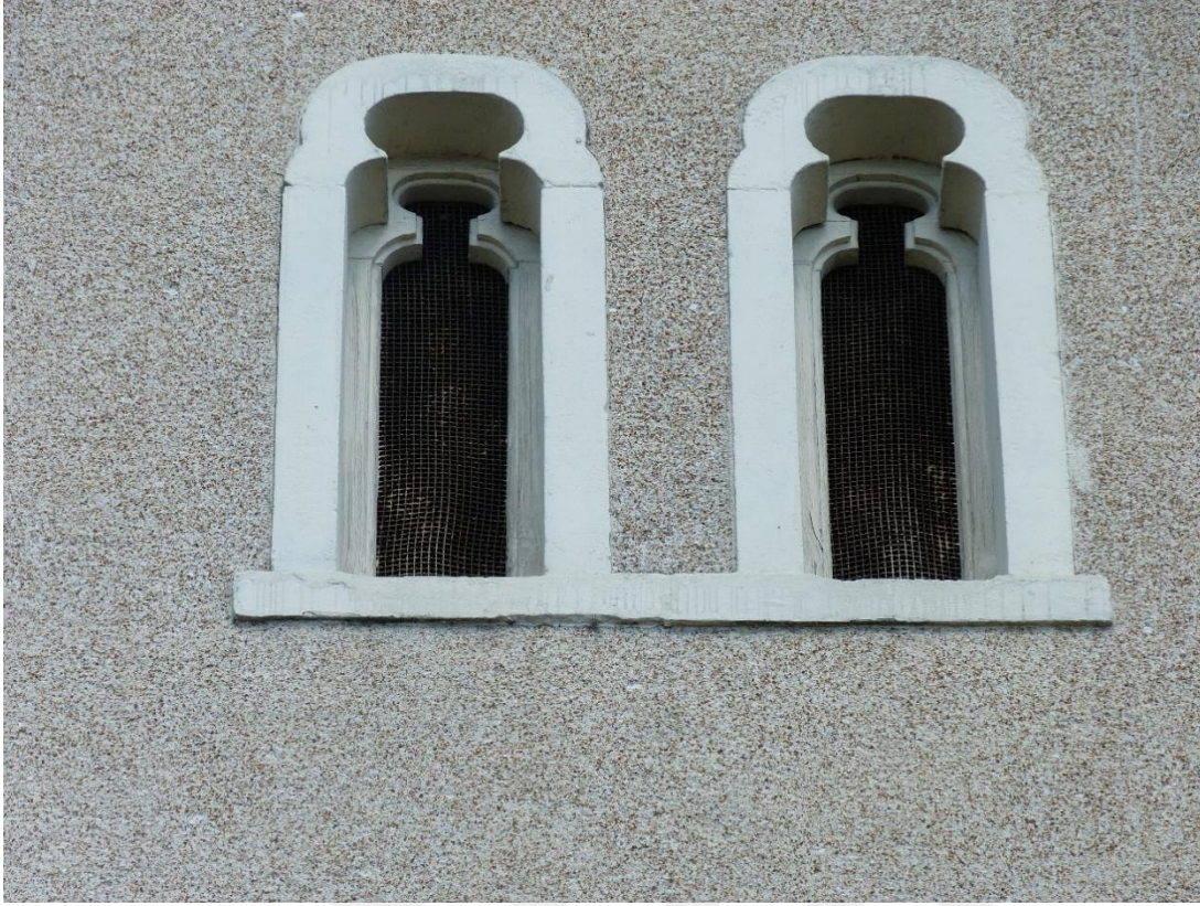
Şekil D.21 : Güneydoğu cephesi çatı pencereleri altında akma izleri.
