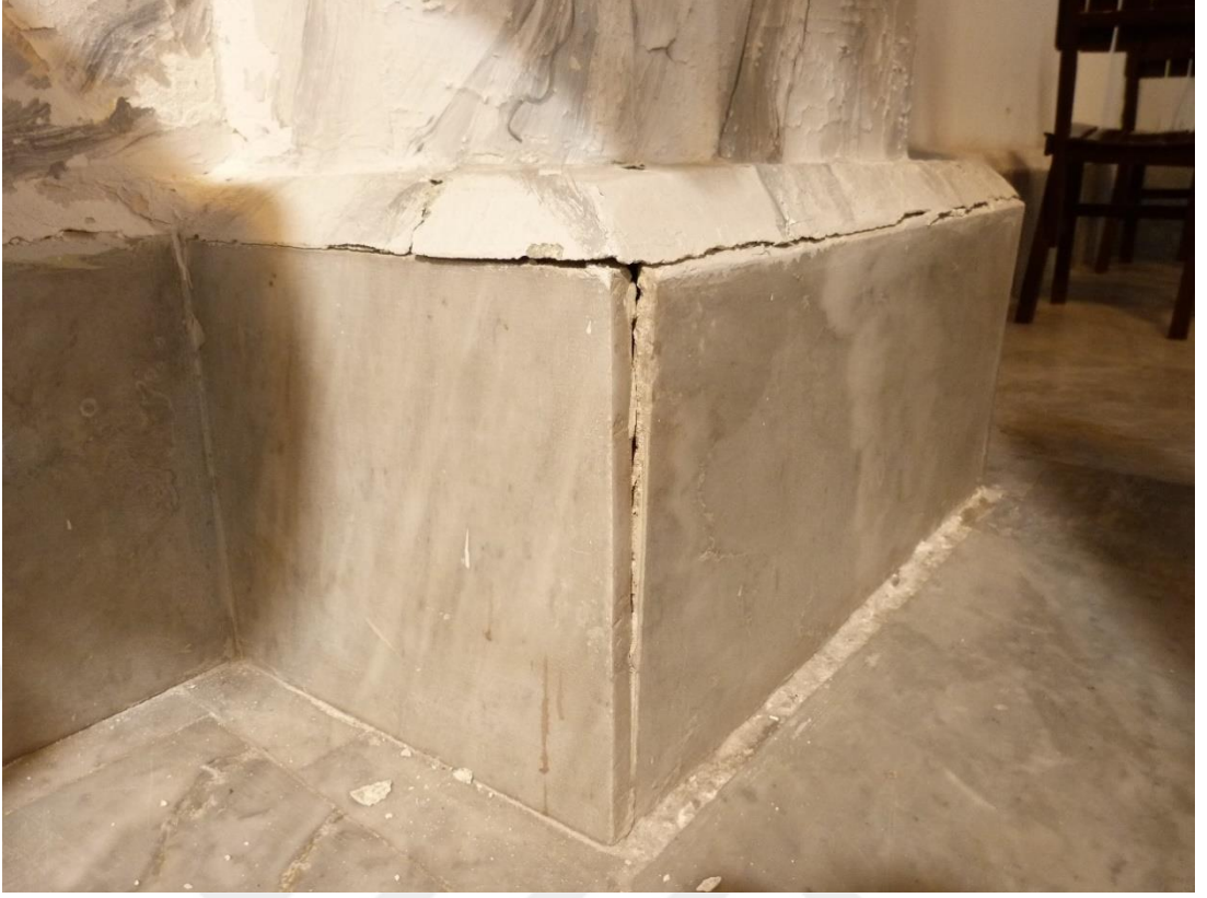
Şekil D.7 : Plastır kaidesinde harcın kalkması ve bağlayıcı malzemenin gevrekleşmesi.
