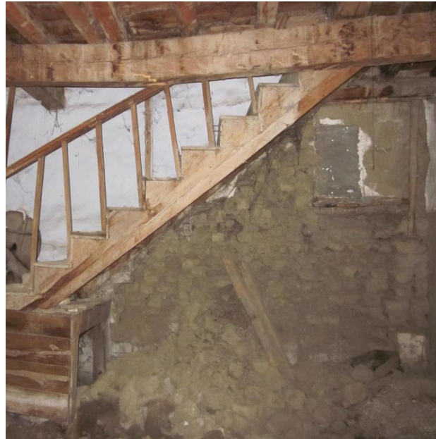
Şekil 4.75: B01 nolu oda yıkılan duvar, 2019.
