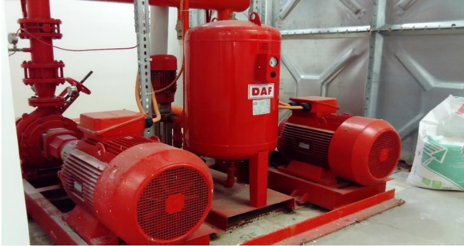
Şekil 6.6 : Tesise ait hidrafor motorları.
